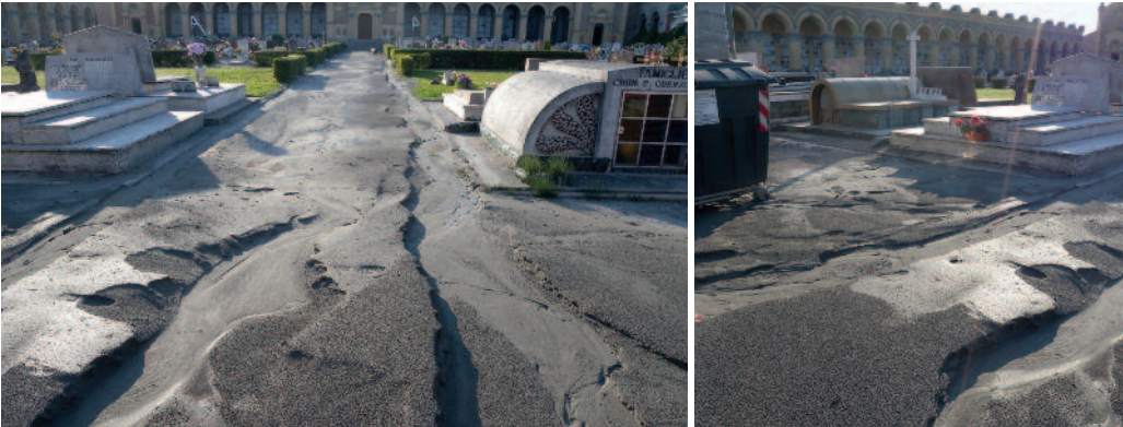
Figura 12 Effetti della liquefazione al Sito 4, localizzato vicino al cimitero di San Carlo, investigato dalla squadra "Geo" di Eucentre dopo l'evento del 20 maggio.
