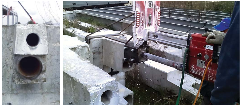
Figura 9 Edificio 2_Carotaggio del perno di fissaggio pilastro-trave per sostituzione con barra di ancoraggio Ø26.
