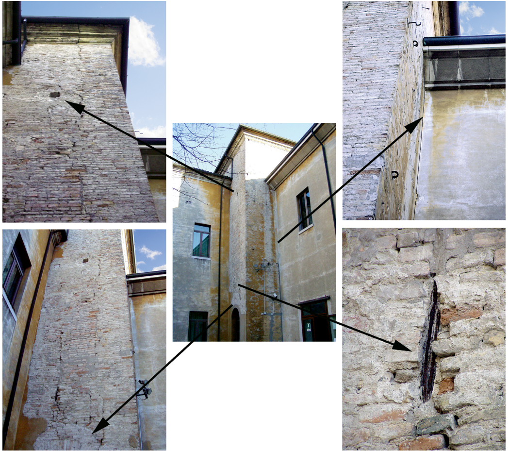
Figura 20 Vista dell'antica torre muraria giuntata con i due corpi di fabbrica più recenti con fessure verticali.
