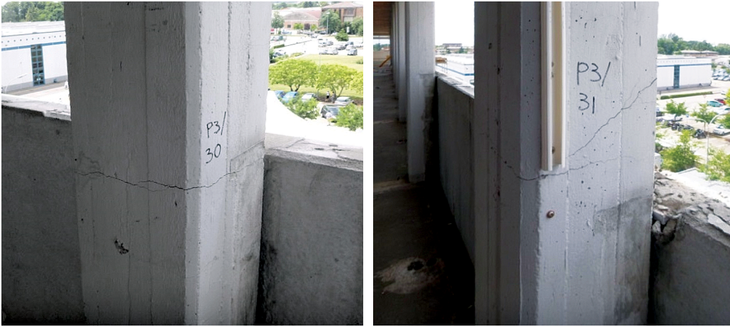
Figura 2 Danneggiamenti dei pilastri in conglomerato cementizio armato.
