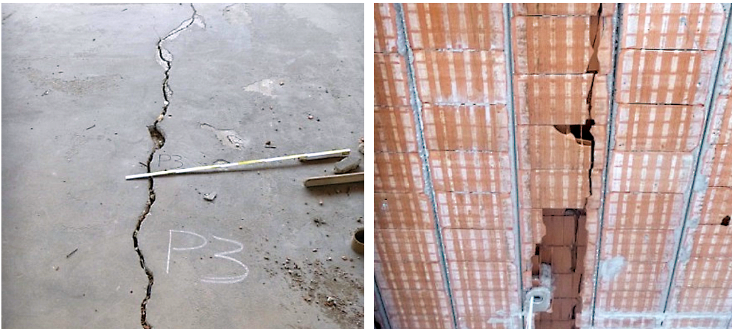
Figura 3 Lesioni passanti sui solai.
