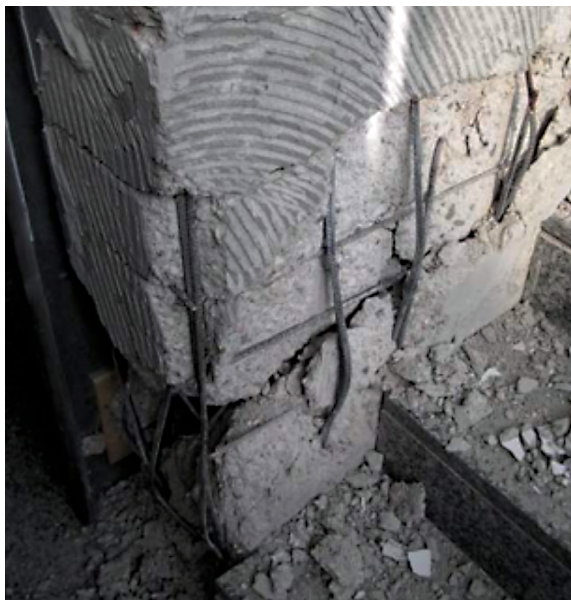
Figura 1 Danneggiamenti sui setti del vano scala e ascensore.
