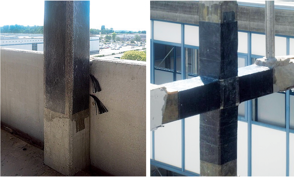
Figura 11 Consolidamento mediante FRP di alcuni pilastri della sovrastruttura e alcuni nodi trave-pilastro.
