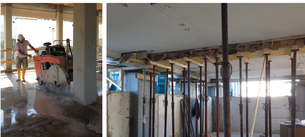
Figura 17 Esecuzione al primo solaio di nuove travi nella direzione ortogonale ai telai in conglomerato cementizio armato.
