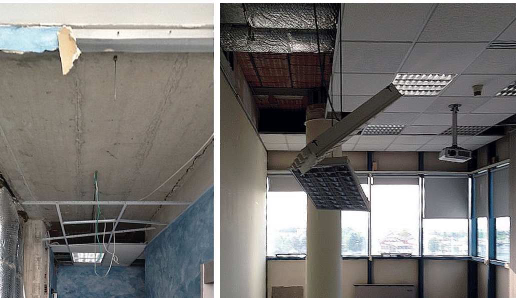
Figura 4 Croli parziali di controsoffittature e impianti tecnologici, danni alle attrezzature interne.
