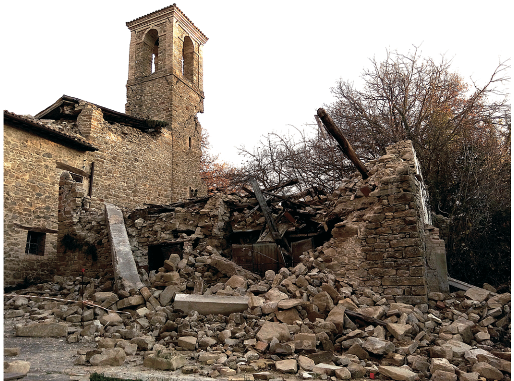
Figura 14 Dettaglio collasso fabbricato accessorio della chiesa, cordolo in calcestruzzo in primo piano.
