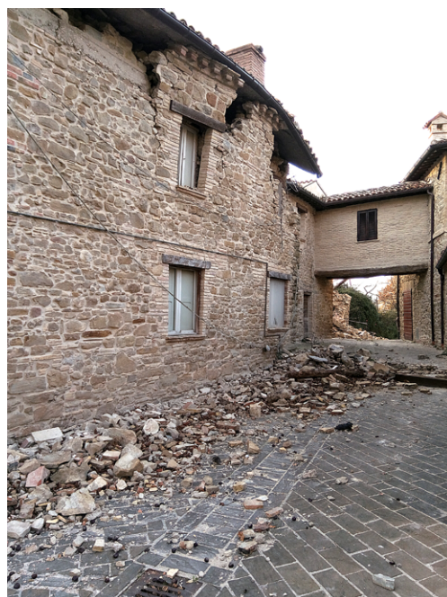
Figura 15 Evidente è lo scivolamento del coperto del fabbricato, con espulsione di materiale con scarsa qualità del legante. Non sono visibili catene all'esterno in grado di contrastare il ribaltamento fuori dal piano (a sinistra).
