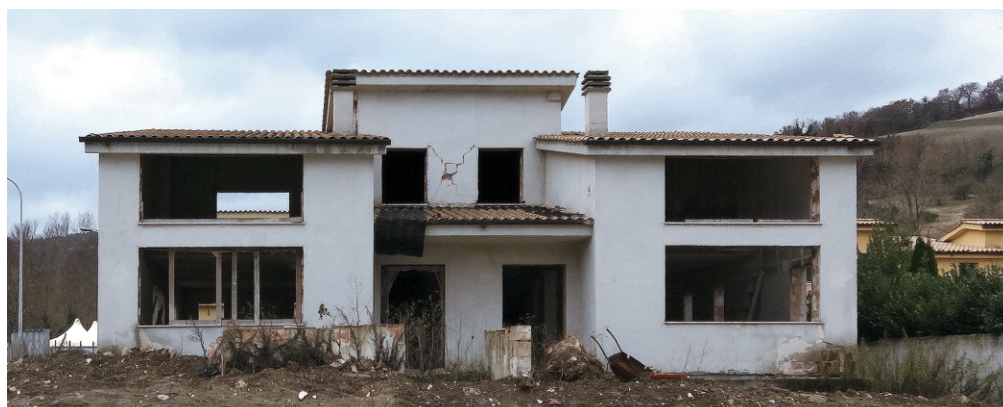
Figura 2 Alcune lesioni sono state riscontrate anche in fabbricati in costruzione al momento del sisma.
