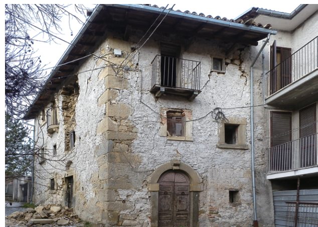
Figura 24 Edificio 17 pre sisma post sisma in data 1/12/2016 (in basso).
