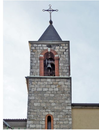
Figura 27 Cella campanaria Santa Caterina d'Alessandria pre sisma e post sisma in data 1/12/2016.
