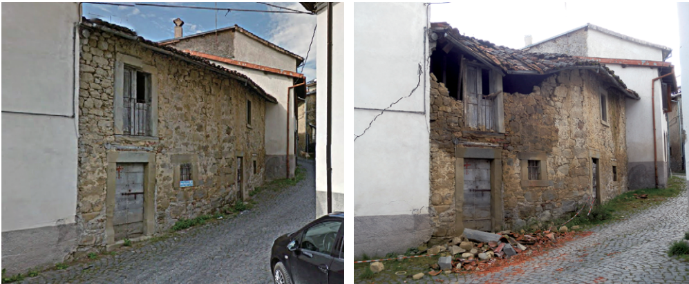
Figura 23 Edificio 12 pre sisma e post sisma in data 1/12/2016.
