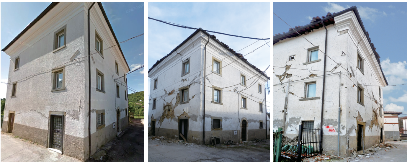
Figura 11 Edificio 5 pre sisma post sisma in data 1/12/2016.
