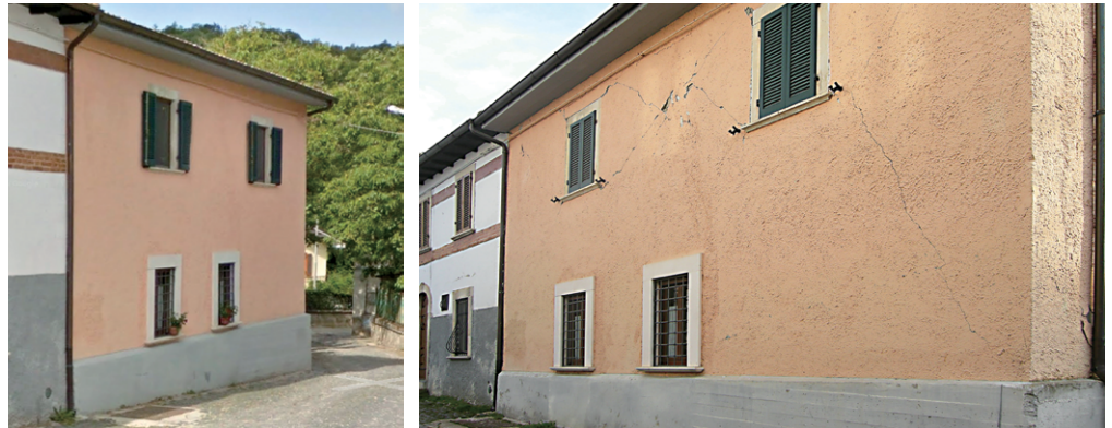
Figura 6 Edificio 4 pre sisma e post sisma in data 1/12/2016.
