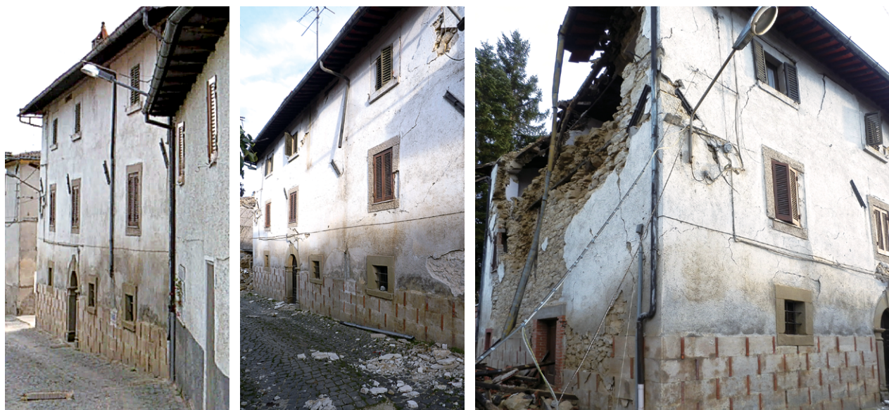
Figura 22 Edificio 6 pre sisma e post sisma in data 1/12/2016 (in basso).
