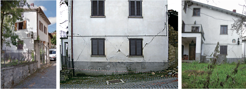
Figura 9 Edificio 13 pre sisma e post sisma in data 1/12/2016.
