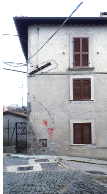
Figura 25 Edificio 16 pre sisma e post sisma in data 1/12/2016.
