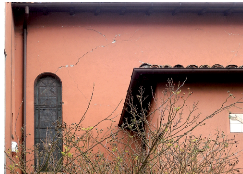
Figura 29 Chiesa di San Sebastiano pre-sisma e post sisma in data 1/12/2016.
