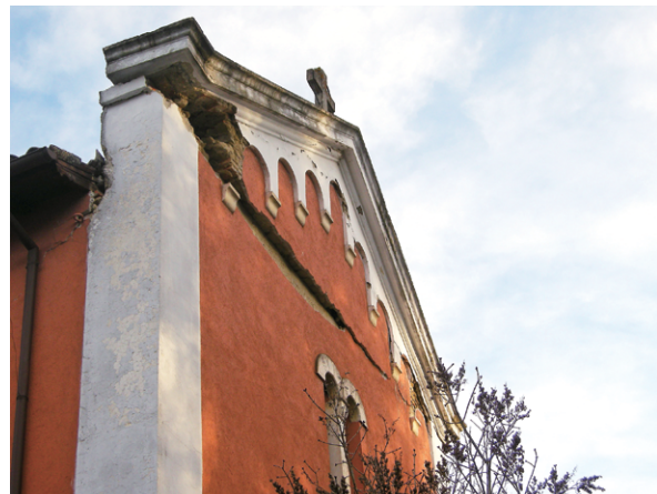
Figura 30 Chiesa di San Sebastiano pre-sisma e post sisma in data 1/12/2016 (in basso).
