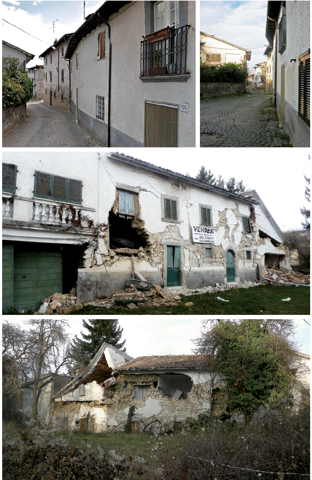
Figura 16 Edificio 19 pre sisma e post sisma in data 1/12/2016.
