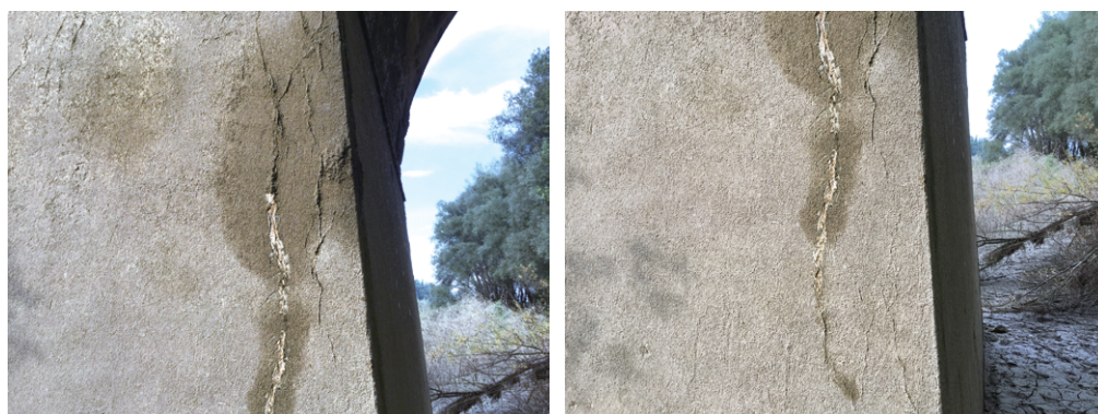
Figura 8 Fessurazione rilevata sulle pile dopo il terremoto del 24 agosto 2016.
