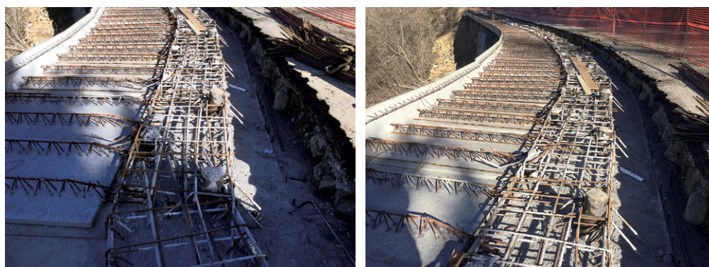
Figura 6 Interventi di somma urgenza per la messa in sicurezza per il Ponte Tre Occhi.
