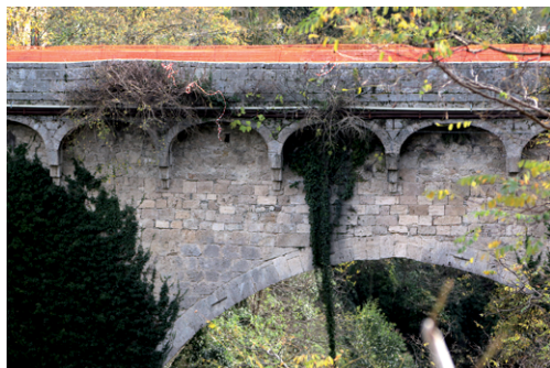
Figura 10 Ponte di Mozzano: vista laterale: vista frontale ed interna del danneggiamento del parapetto murario.
