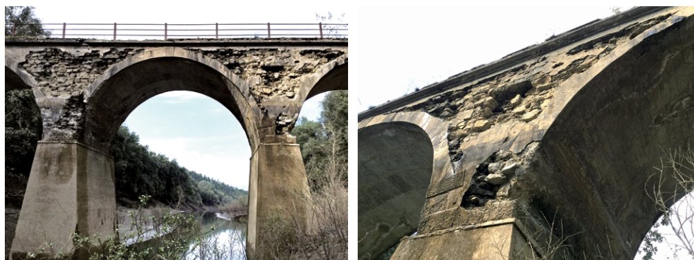
Figura 7 Stato di fatto del Ponte Cinque Occhi dopo l'evento sismico del 24 agosto 2016.
