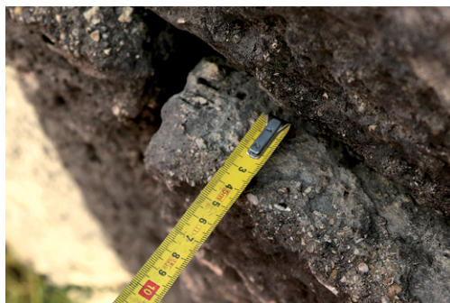
Figura 11 Spostamenti rilevati dei blocchi lapidei costituenti il parapetto.
