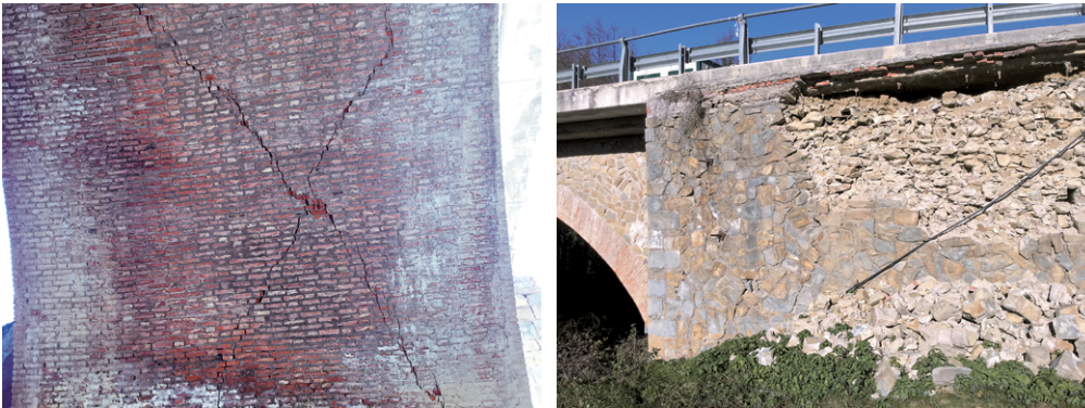
Figura 6 Lesioni diagonali all'intradosso dell'arco e muro d'ala posti in prossimità della spalla Est.
