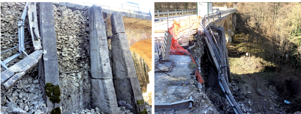
Figura 7 Collassi lungo il muro d'ala posto a Nord, in prossimità della spalla Est.
