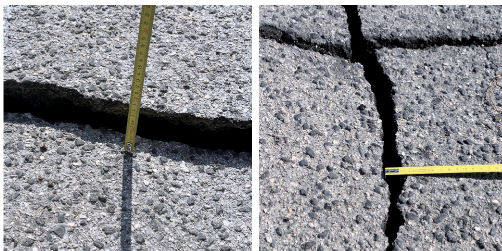
Figura 4 Lesioni riportate nella pavimentazione della carreggiata del Ponte "Tre Occhi".
