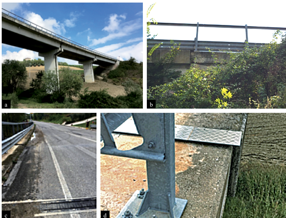
Figura 17 Viadotto in c.a. lungo la SP173, coordinate 42.941687 N, 13.702294 E: (a) vista generale del ponte; (b) abbassamento della sede viaria in corrispondenza di una spalla; (c) lesioni del manto della pavimentazione in corrispondenza di una spalla; (d) spostamenti relativi della spalla.
