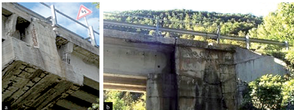
Figura 16 Danni da martellamento e danni pregressi ai viadotti in c.a.: (a) danni al traverso e al diaframma trasversale lungo la SS685, coordinate 42.756556 N, 13.277111 E; (b) danni ad una spalla lungo la SS4, coordinate 42.699565 N, 13.251978 E (per concessione di Totaro).
