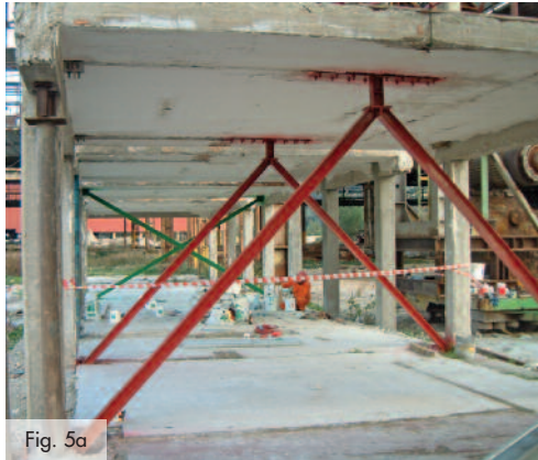
Fig. 5. Struttura consolidata mediante controventi eccentrici ad Y rovescia: (a) posizione dei controventi; (b) dettaglio del collegamento fra controventi e struttura in c.a.
