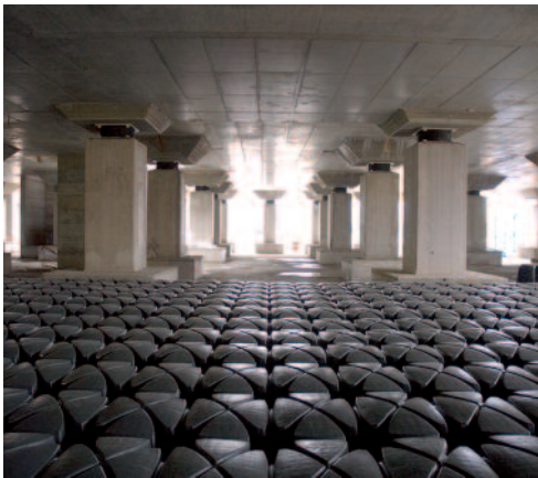
Fig 23 Piano tecnico in cui sono installati gli isolatori e parti- colare dell'appoggio dei dispositivi.
