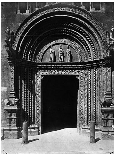
Fig. 2 1884: il portale presenta nell'archivolto molte cadute di materiale lapideo soprattutto nella parte alta più esposta agli agenti atmosferici. L'ala del grifo di sinistra è spezzata.
