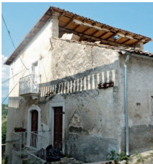
Fig. 50 Vallecupa: canna fumaria messa in evidenza dal sisma.
