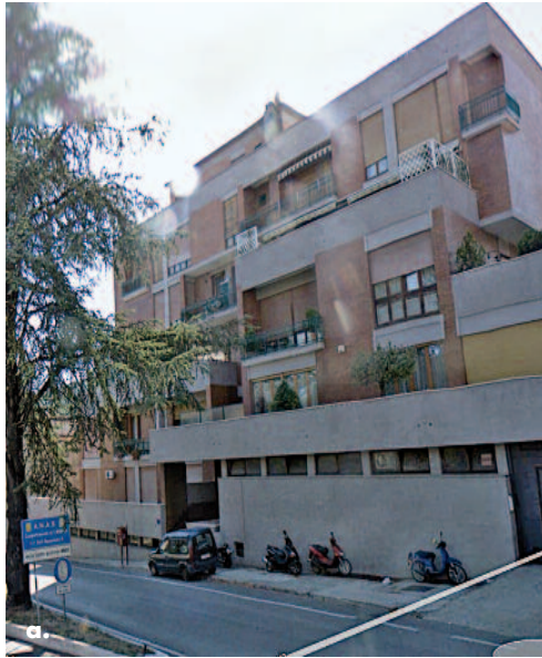
Fig. 16 Collapsi per meccanismi di piano soffice: edifici siti in Via Porta Napoli (a), (b) ed in Via Dante Alighieri in località Pettino (c), (d), (e), (f).
