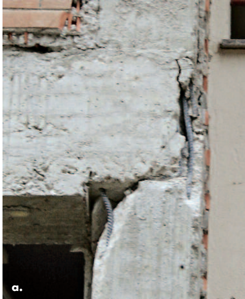
Fig. 11 Crisi in corrispondenza dell'interfaccia nodo- pilastro.
