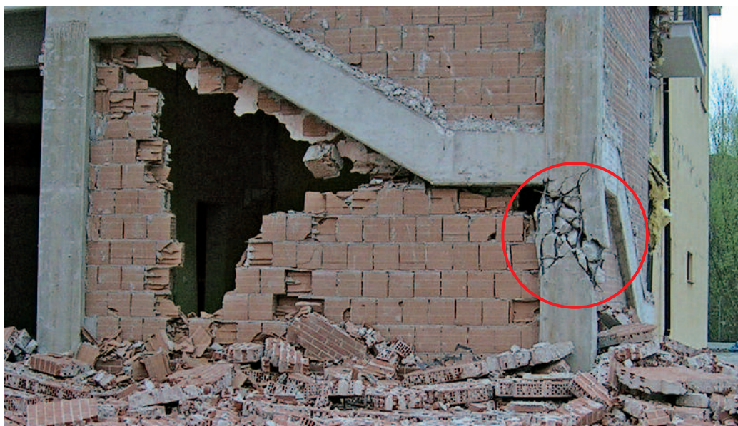
Fig. 8 Crisi a taglio di un pilastro tozzo di una scala.
