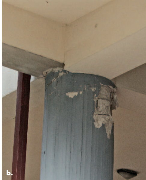
Fig. 5 Pilastro con barre lisce ed insufficiente armatura trasversale (a); crisi pressoflessionale di un pilastro circolare (b).
