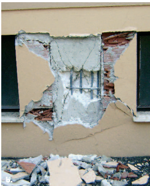
Fig. 7 Crisi a taglio di pilastri adiacenti ad una tamponatura parziale (a); crisi a taglio di un pilastro tozzo adiacente alle pareti di un seminterrato (b).
