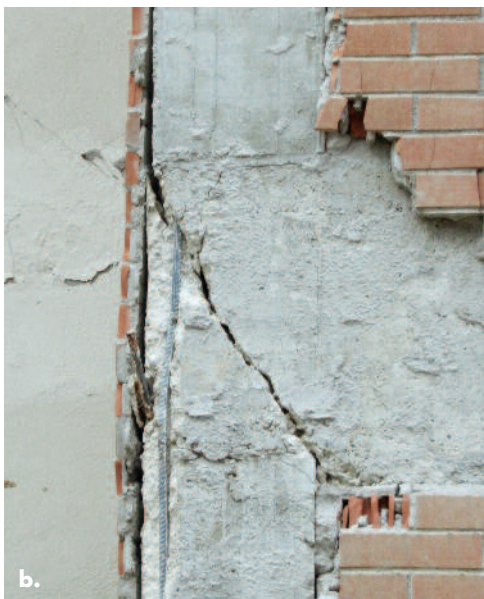
Fig. 10 Crisi di un pannello di nodo non staffato con evidente buckling delle armature compresse (a); crisi per fessurazione diagonale di un pannello di nodo (b).
