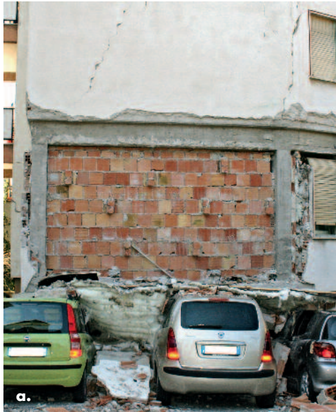
Fig. 14 Crisi della fodera esterna della tamponatura.
