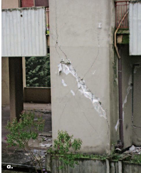
Fig. 9 Danneggiamento subito dalle pareti in c.a.
