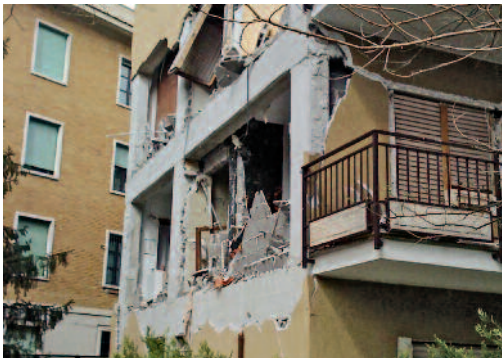
Fig. 9 Espulsione delle tamponature in edificio con struttura eseguita in opera.
