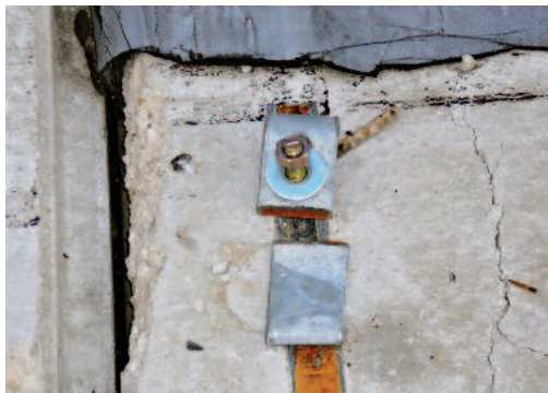
Fig. 17 - 18 Cedimento per tranciatura delle piastrine metalliche.
