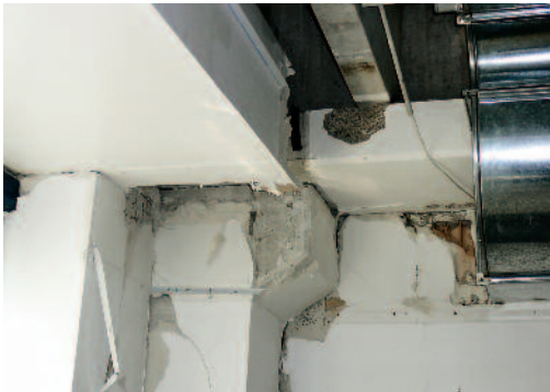
Fig. 7 Danni locali alla sommità di un pilastro interno.
