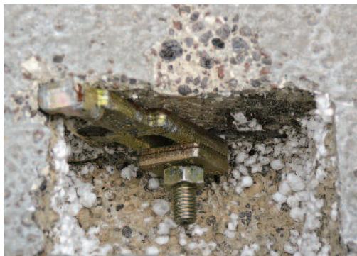
Fig. 19 Cedimento per tranciatura delle piastrine metalliche.
