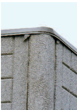
Fig. 11 Distacco di pannelli prefabbricati di facciata, presso un angolo.
