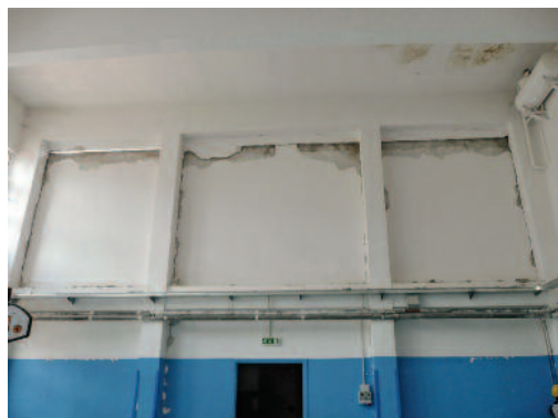
Fig. 4 Danni alla tamponatura della palestra della scuola elementare di Paganica.
