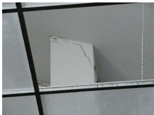
Fig. 6 Lesione ad un pilastro della scuola elementare Celestino V.
