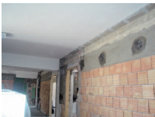
Fig. 12 Prospetto interno della scuola elementare del Torrione dopo il rafforzamento dei nodi.
