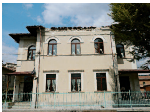
Fig. 8 Crollo parziale della copertura della scuola elementare S. Elia.
