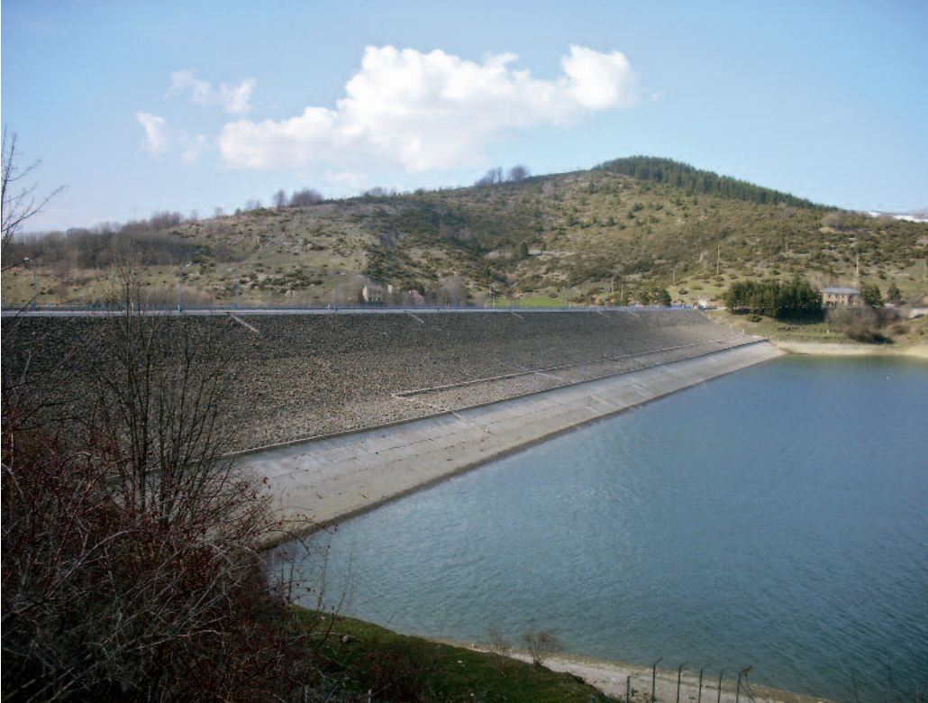
Fig. 2 Diga in terra Poggio Cancelli, bacino di Campotosto (AQ): paramento di monte della diga rivestito da una scogliera di pietrame arenaceo.
