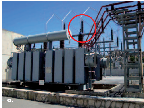
Fig. 5 (a) Danno alla connessione rigida in cima a un trasformatore. (b) Tipico danno ad una scatola di connessione.
