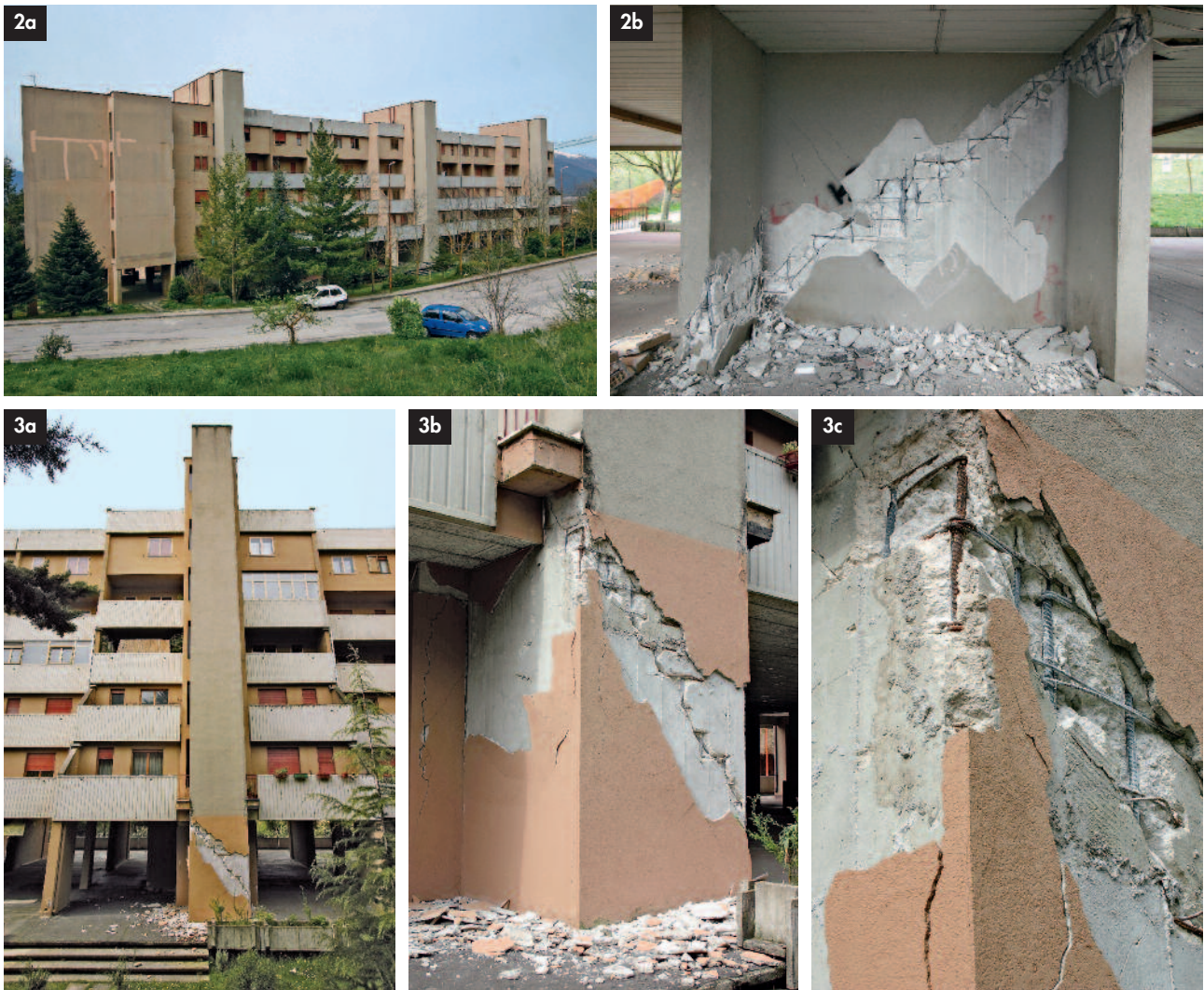
Fig. 2 Edificio aquilano irrigidito da setti in CA (a) e rottura fragile per taglio di uno di essi (b).
