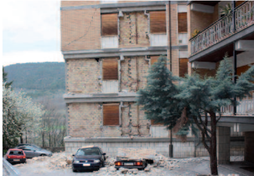
Fig. 4c Danneggiamento per azioni fuori dal piano: esempi di espulsione del paramento esterno e collasso per formazione della "cerniera verticale" nel paramento interno.
