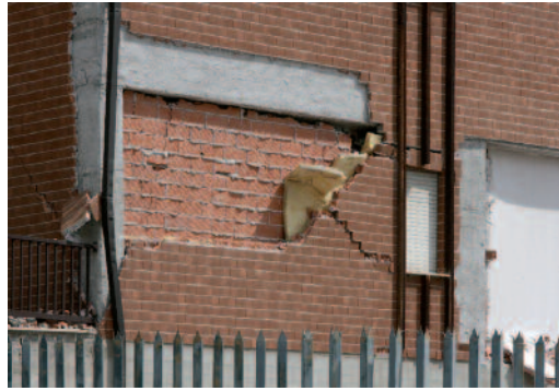
Fig. 3a Danneggiamento per azioni nel piano: distacco della tamponatura dal reticolo strutturale.
