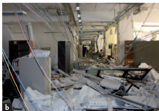
Fig. 7 Collapsi di partizioni interne realizzate con blocchi di laterizio (a) e pannelli di gesso (b).
