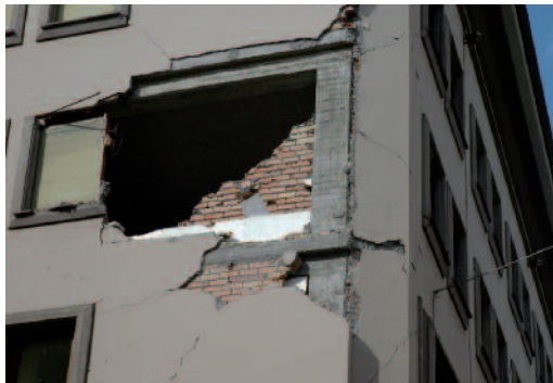
Fig. 5 Esempi di collasso di tamponature con paramento esterno collocato al di fuori del reticolo strutturale.
