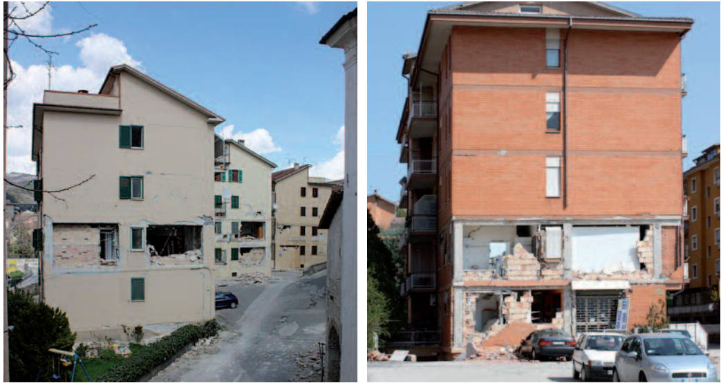
Fig. 10 Esempi di danneggiamento di tamponature collocate ai primi livelli di strutture intelaiate in c.a.
