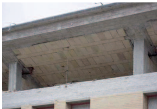
Fig. 6b Facciata dell'Ospedale San Salvatore dopo il sisma del 6 aprile 2009.
