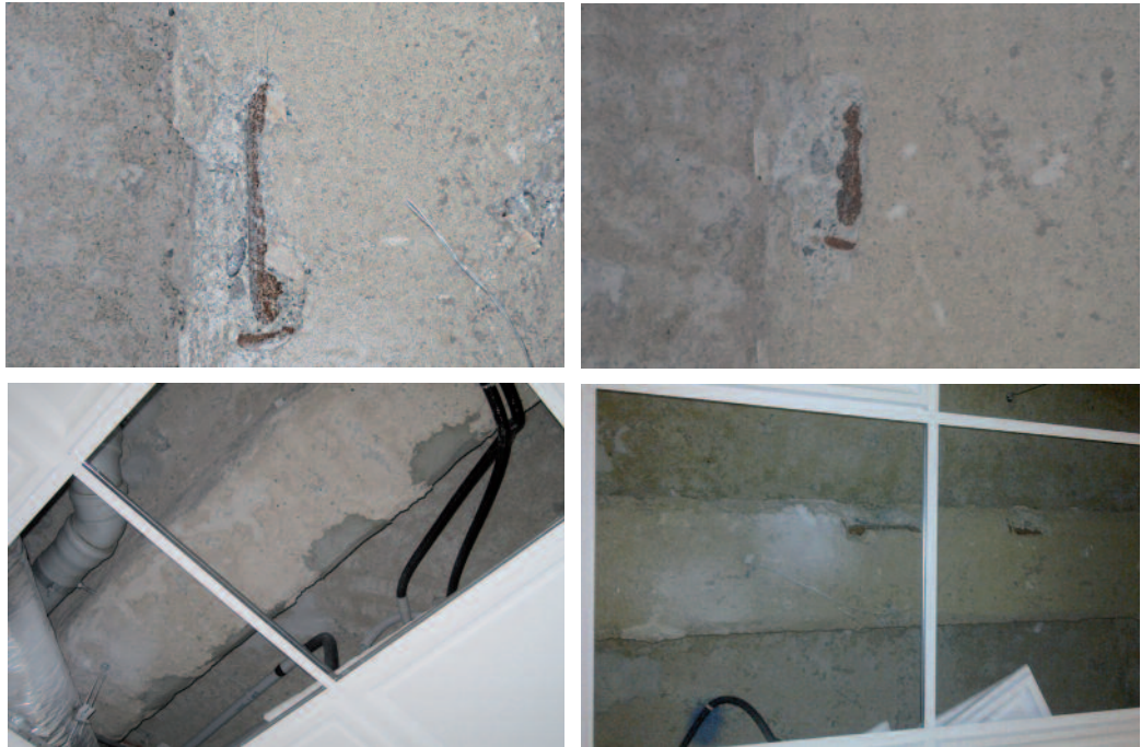
Fig. 11 Travi emergenti rispetto la controsoletta intradossale: espulsione del copriferro.
