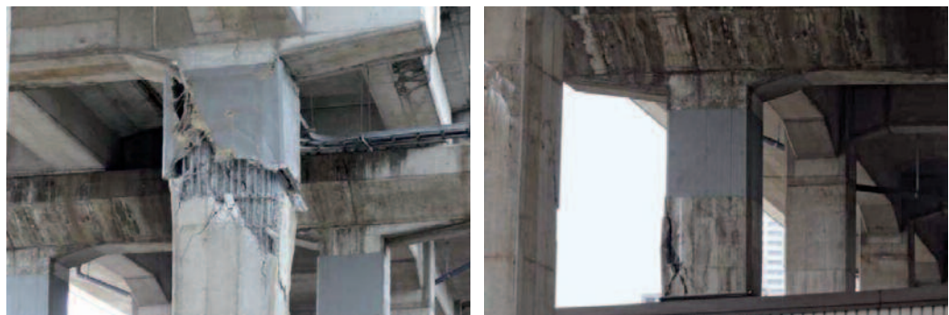
Figura 14 Zona di Asuto Nagamachi 2- chôme: rottura della fibra di rinforzo alla sommità di una pila del viadotto dell'alta velocità (a sinistra) e rottura per taglio al di sotto dello strato di fibrorinforzo in un'altra pila (a destra).
