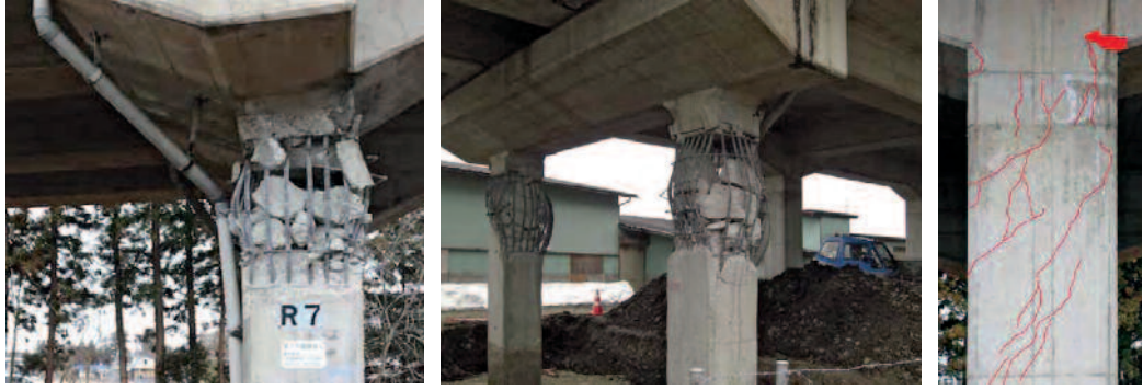
Figura 22 Piastra identificativa indicante l'anno di costruzione posta sulla pila R7-1 (a sinistra), rottura del nucleo in sommità della pila R7-4 (al centro) e danneggiamento alla base della pila R7-3 (a destra).
