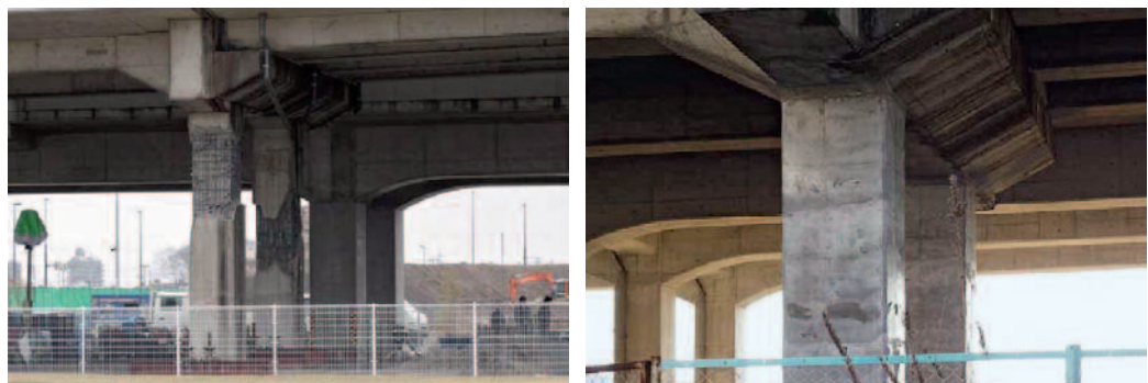
Figura 13 Zona di Asuto Nagamachi 2- chôme: confronto fra il viadotto della linea Shinkansen costruito nel 1982 e della Tohoku Line costruita nel 2006 (a sinistra) e dettaglio di una pila ad intervento di riparazione completato (a destra).
