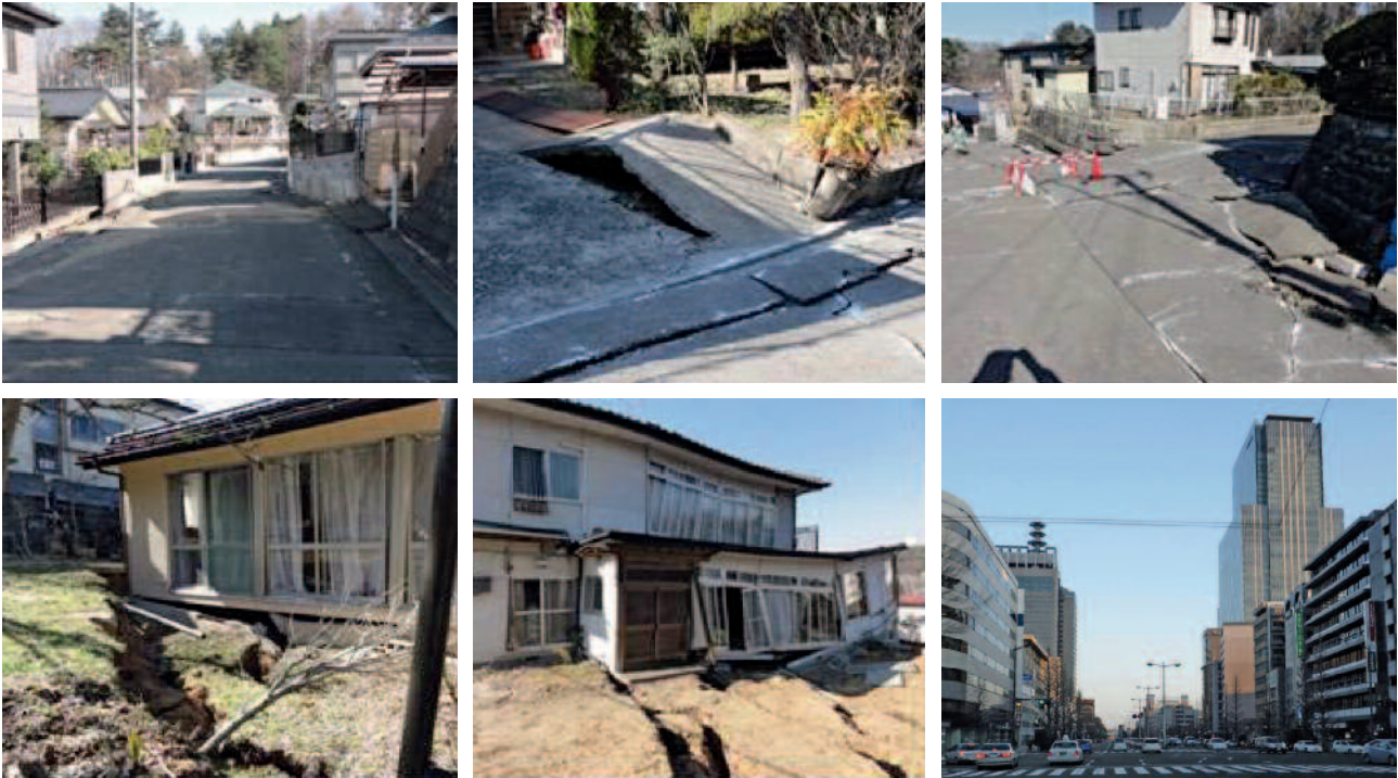
Figura 11 Oritate 5-chôme - Cambiamento di direzione di una strada precedentemente rettilinea (a sinistra) e testimonianze del danneggiamento del manto stradale (al centro e a destra).
