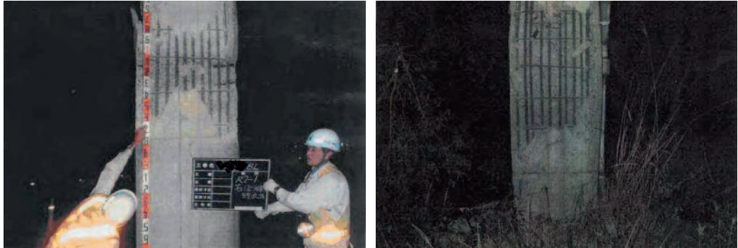
Figura 23: Danneggiamento della pila R1 del viadotto Odaki n.3 (a sinistra) e della pila R1 del viadotto Nakano n.2 (a destra).
