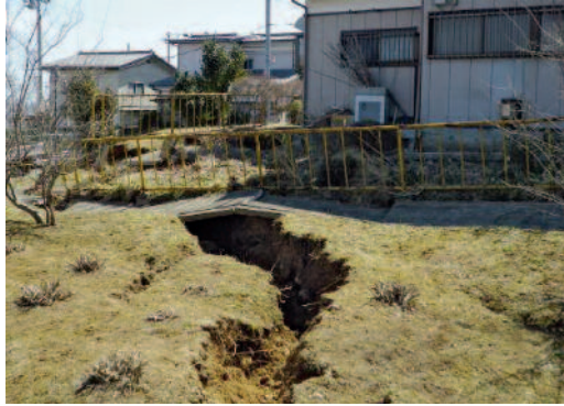
Figura 36 Collasso per in stabilizzazione di un terreno residenziale a Midorigaoka (Sendai).
