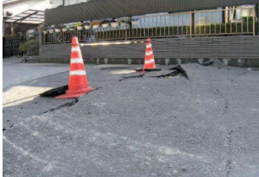
Figura 28 Distorsione differenziale della pavimentazione stradale in una zona residenziale di Mihama di Chiba.
