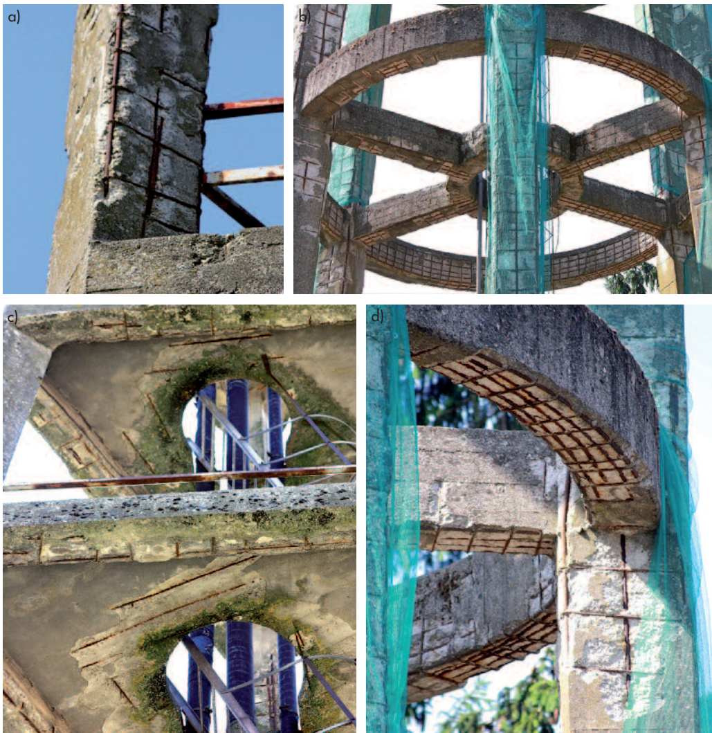
Figura 6 Stato di danneggiamento delle strutture di supporto: a) dettaglio nodo serbatoio 30 m 3 b) travi serbatoio 130 m 3 c) vista solette serbatoio 30 m 3 d) dettaglio nodo serbatoio 130 m 3 .
