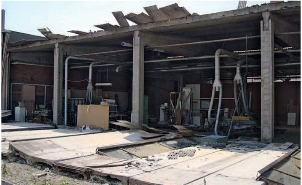
Figura 5 Collasso di pannelli di tamponatura di un edificio industriale.
