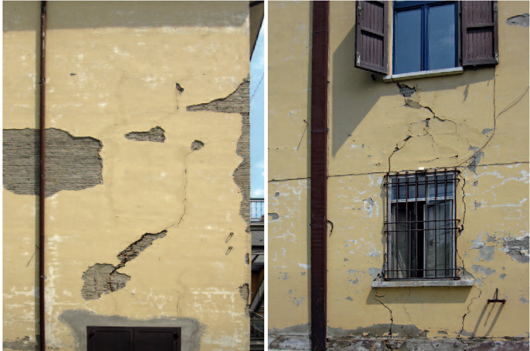
Figura 1 Scuola Gonelli - Mirabello - Esito E - Muratura.
