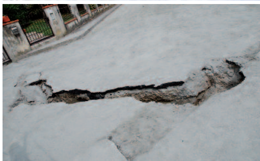
Figura 14 Rilievo dissesti al terreno Prove Geofisiche – zona San Carlo.
