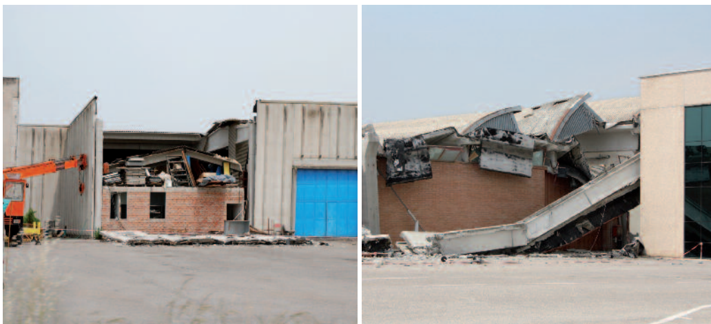
Figura 10 Rilevi strutture prefabbricate (Mirabello, Massa Finalese, Mirandola).
