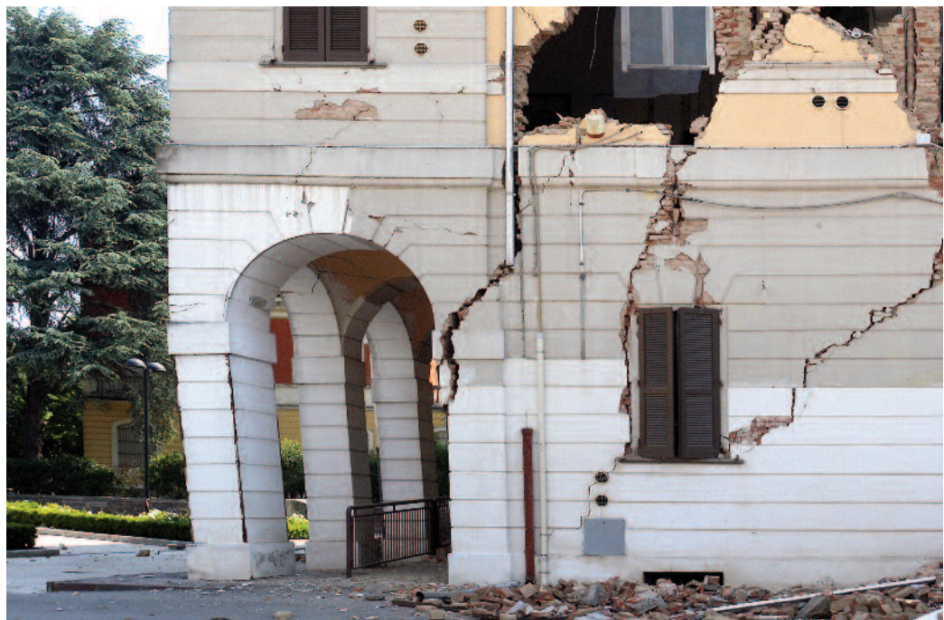
Figura 9 Rilievo danni strutture in muratura (Municipio di Sant'Agostino).
