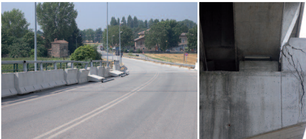
Figura 11 Rilevio danni sulle strutture da ponte - Crevalcore.
