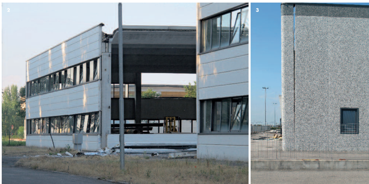
Figura 2 Mirandola - Edificio prefabbricato con elementi di copertura precompressi e pannelli di chiusura esterni prefabbricati orizzontali.
