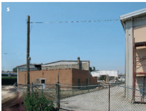
Figura 4 S. Felice sul Panaro - Edificio prefabbricato con pannelli in muratura regolari, solo leggermente danneggiato dal terremoto.
