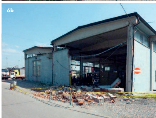
Figura 6 Crolli causati da pannelli di tamponamento in muratura irregolari a causa della presenza di finestre a nastro. Il prefabbricato di Figura 6(c) è quello la cui foto all'interno prima del sisma è riportata in Figura 1.
