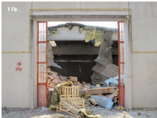
Figura 11 Mirandola - Caduta di elementi prefabbricati di copertura per perdita di appoggio, senza alcun danno evidenti nei pilastri verticali.
