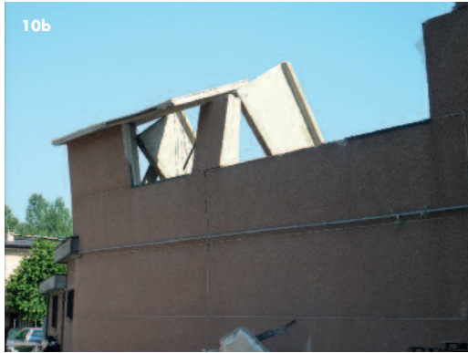
Figura 10 Crollo di un edificio prefabbricato di recente costruzione.
