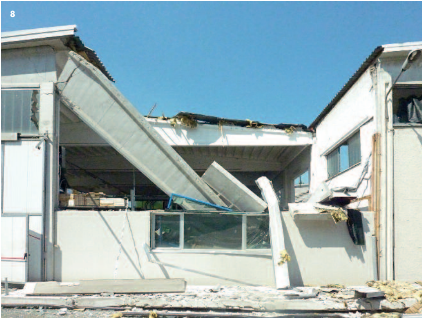
Figura 8 S. Felice sul Panaro. Crollo della travata esterna a causa della interazione con un pilastro non strutturale di facciata.
