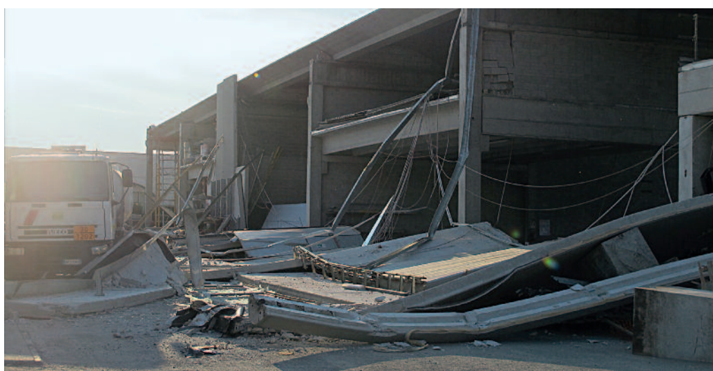
Figura 18 Caduta di pannelli sandwich di tamponamento verticali non vincolati alla fondazione.
