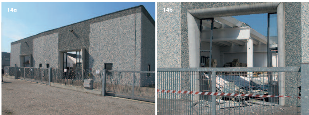
Figura 14 Crollo completo di un edificio industriale, con crisi dei pilastri centrali.
