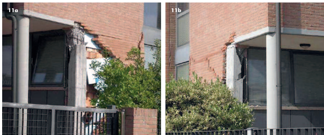
Figura 11 San Felice sul Panaro, danni significativi a elementi in cemento armato prodotti da interazione locale con tamponatura in laterizio; (Decanini et al., 2012).
