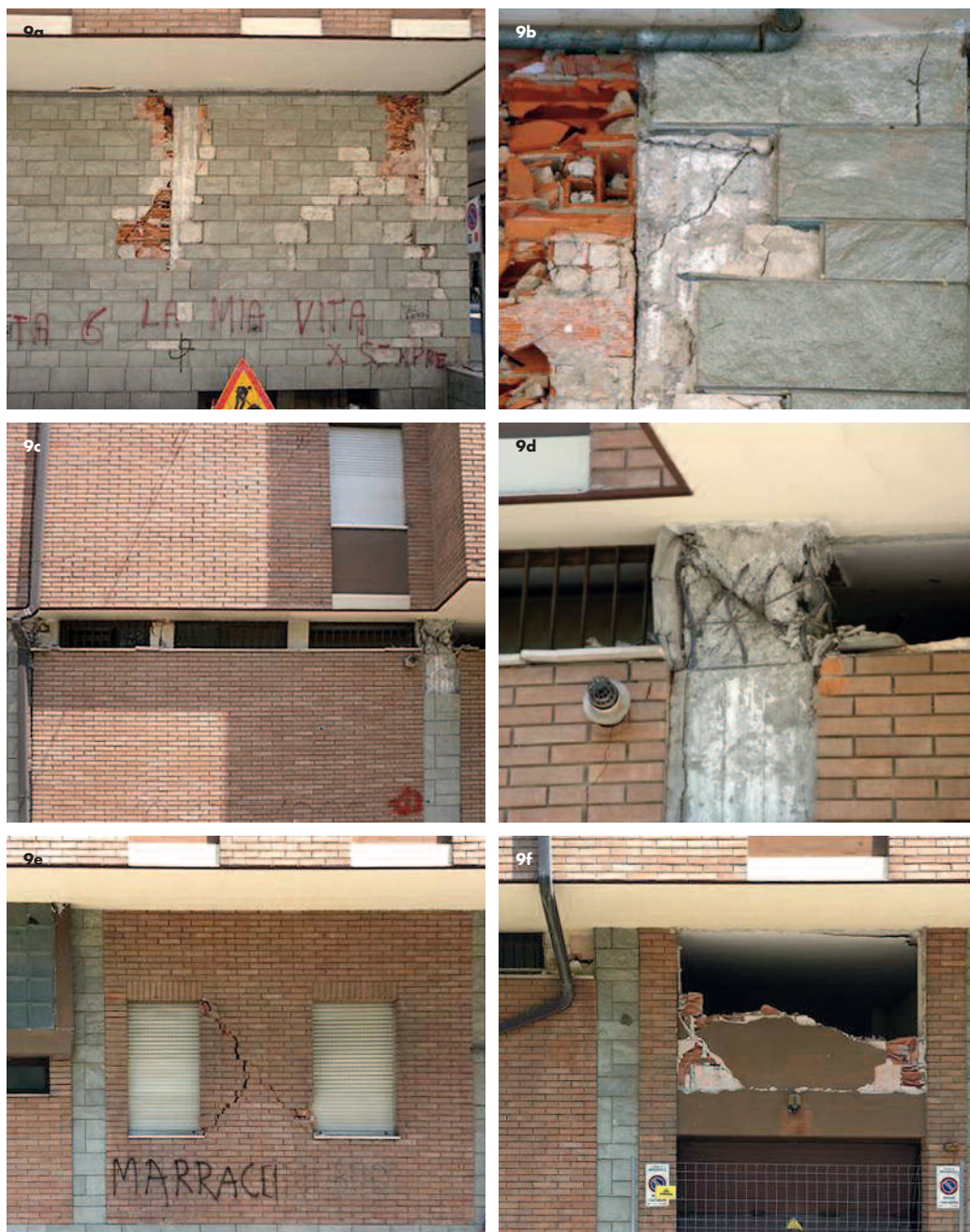
Figura 9 Mirandola, (a) fodera esterna di tamponatura danneggiata al primo livello di un edificio, (b) fessurazione diagonale caratteristica di crisi taglianti alla testa di colonna in c.a.; danno strutturale ad una colonna tozza in corrispondenza di finestre a nastro come risultato di interazione tra elemento in c.a. e tamponatura, (c) vista globale, (d) particolare colonna; (e) danno moderato e fessurazione diagonale di tamponatura in laterizio tra due vani finestra, (f) danno significativo e collasso parziale di tamponatura in laterizio; (Parisi et al., 2012).
