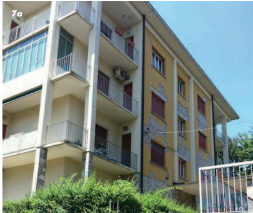
Figura 7 Mirandola, danneggiamento lieve dell'intonaco su tamponamenti in laterizio; (Parisi et al., 2012).
