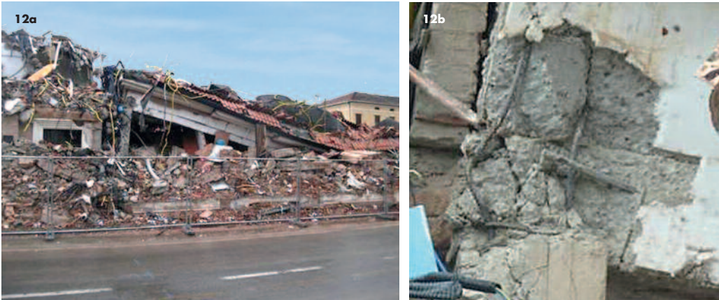
Figura 12 Cavezzo, (a) collasso strutturale di edificio in c.a. tamponato con mattoni forati, (a) particolare di nodo trave-colonna danneggiato e sprovvisto di armatura trasversale; (EPI-FO-290512, 2012).
