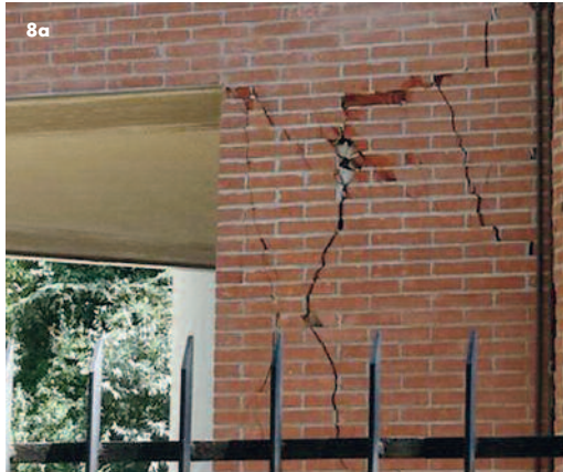
Figura 8 Mirandola, danni moderato alla fodera esterna di tamponamenti in laterizio in assenza di danni agli elementi in c.a. dell'edificio; (Parisi et al., 2012).
