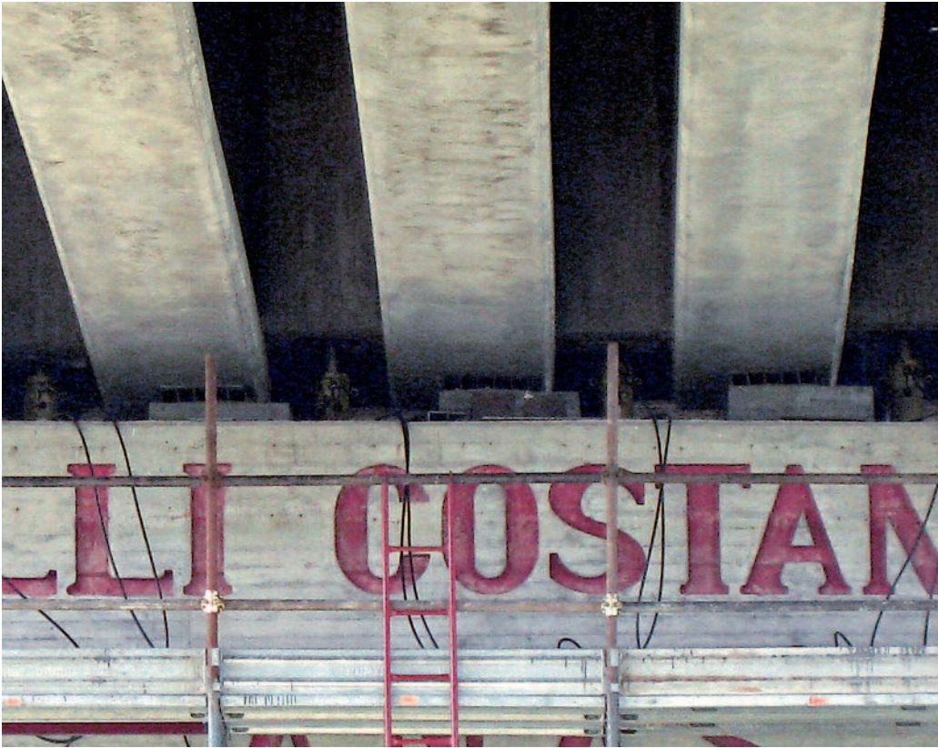
Figure 3 Ponte sulla SP468, particolare della dislocazione sul piano appoggi. Nella foto si vedono anche i martinetti installati per il riposizionamento.
