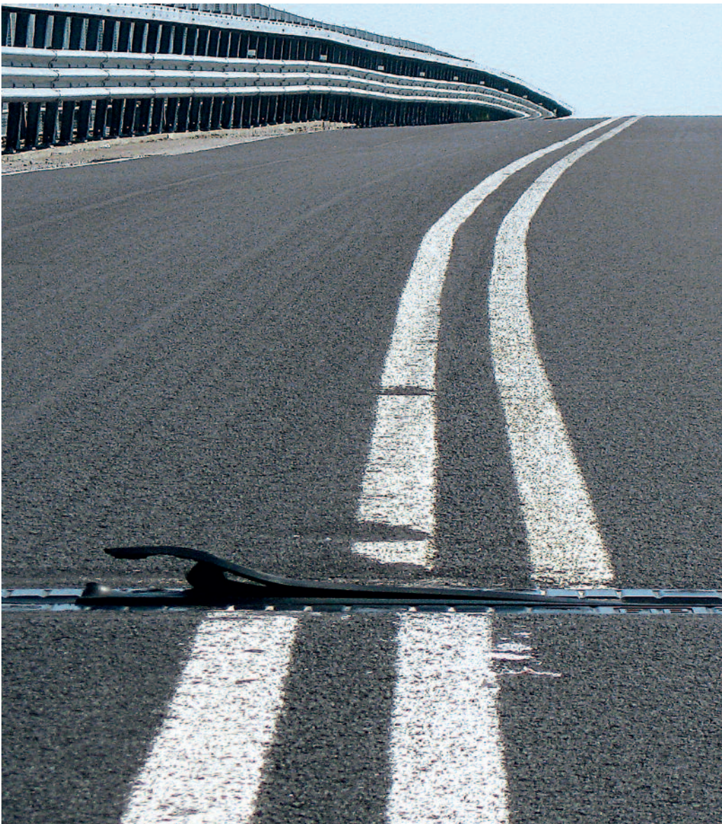
Figure 4 Ponte sulla SP468, dislocazione permanente in corrispondenza di un giunto (aumentata di circa 4 cm dopo le scossa di replica del 29/05/2012, circa 20 cm totali).
