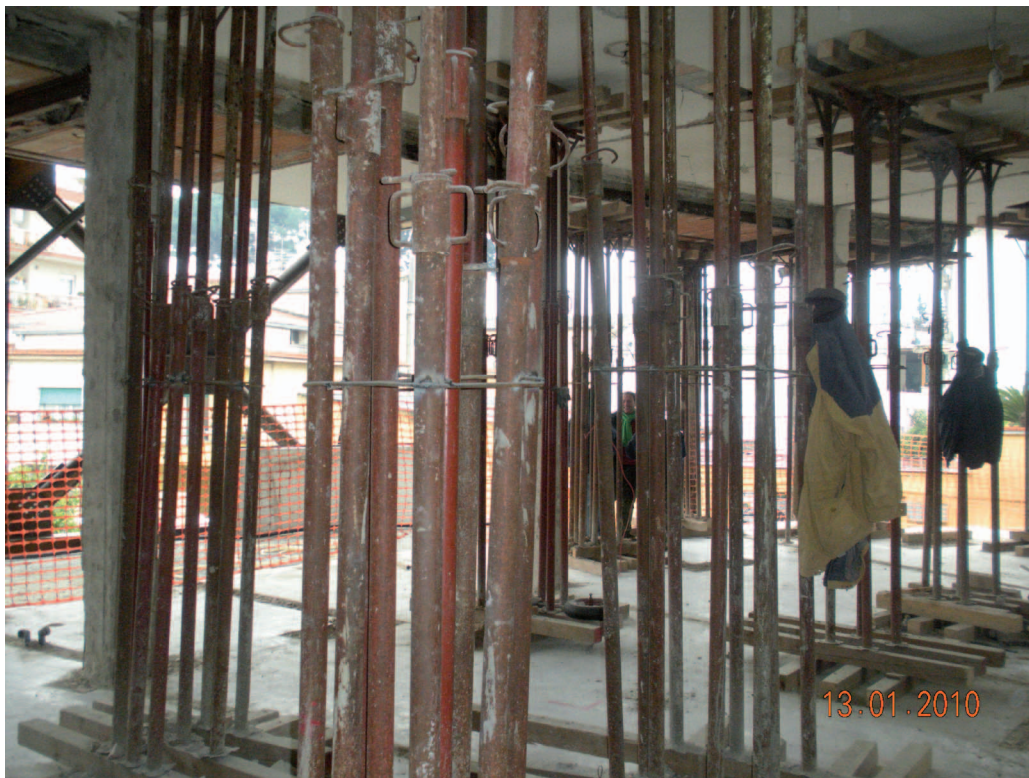
Figura 35 Vista delle opere di presidio provvisorio (puntelli)
