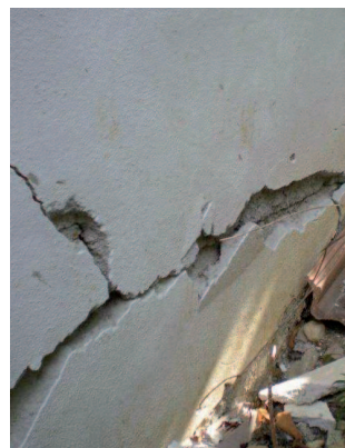
Figura 2 Rilievo preliminare: fratturazioni concentrate, decoesioni localizzate con espulsione di parti e corrugamento intonaci in corrispondenza del prospetto nord-ovest.
