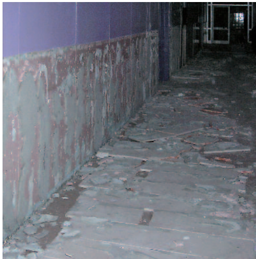
Figura 3 Tipici danni non strutturali rilevati in strutture ospedaliere dopo un terremoto di magnitudine medio-alta.
