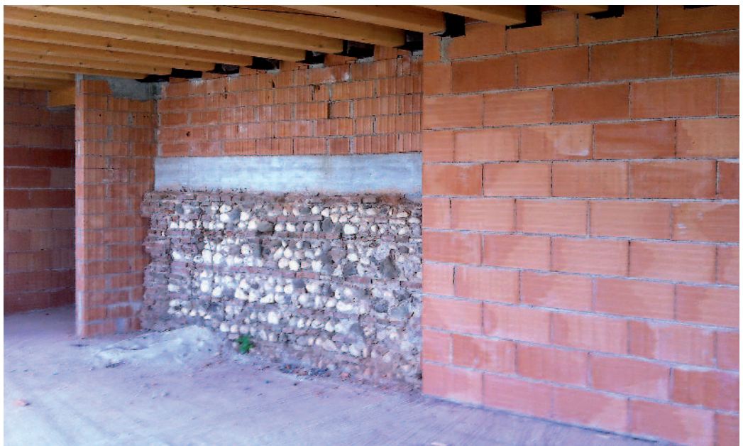
Figura 8 Innesto del solaio su pareti di differenti caratteristiche fisico-meccaniche, integrate fra loro.
