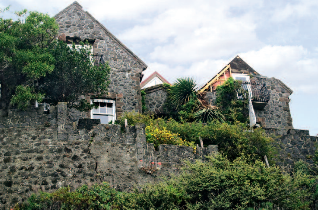
Fig. 3 La casa di Nigel Priestley, su un promontorio a circa 2 km dall'epicentro. L'accelerazione stimata al terreno supera i 2 g. Si notino i crolli dell'architrave della finestra centrale dell'edificio a sinistra, del timpano dell'edificio a destra, del parapetto del terrazzo in corrispondenza della vistosa fessura. I danni sono tali da poter comportare la demolizione dell'edificio. (Courtesy of Nigel Priestley).
