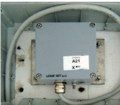
Figura 2 Le componenti principali di un sistema di monitoraggio sismico: (da sinistra a destra) la terna accelerometrica al suolo, un accelerometro fissato sulla struttura, unità per l'acquisizione e la registrazione dei dati.
