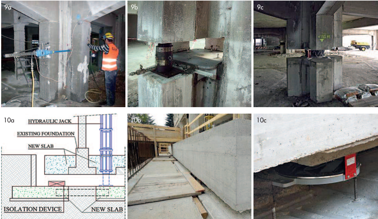
Figura 9 Esempi di introduzione di un isolatore: (9a) taglio del pilastro, (9b) supporto temporaneo, (9c) configurazione finale (costo pari a circa 150 € per metro quadrato di superficie in pianta dell'edificio per gli interventi strutturali, che potrebbero raddoppiarsi a circa 300 €/m 2 se si considerano le misure addizionali richieste)(in alto).
