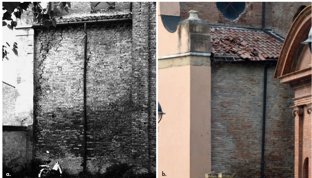
Figura 26 a) Parete laterale dopo il terremoto del 1987. b) Parete laterale dopo l'evento del 2012.
