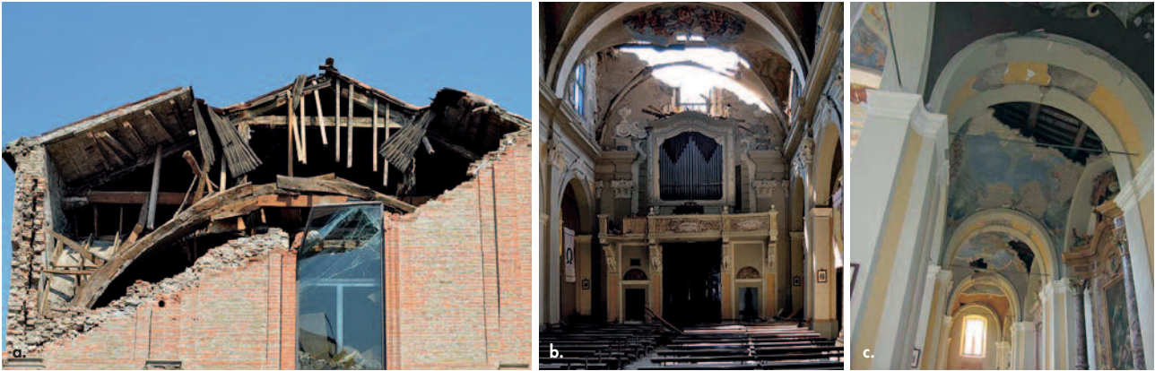
Figura 15 Duomo di Finale Emilia: cinematismo di collasso della sommità della facciata, vista esterna ed interna, e danno alle volte della navata laterale (www.parrocchia- finaleemilia.it).
