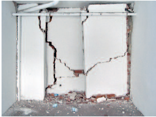
Figura 4 Rilevio del danno: piano terra.
