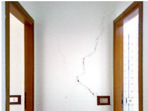
Figura 5 Rilevio del danno: piano primo.
