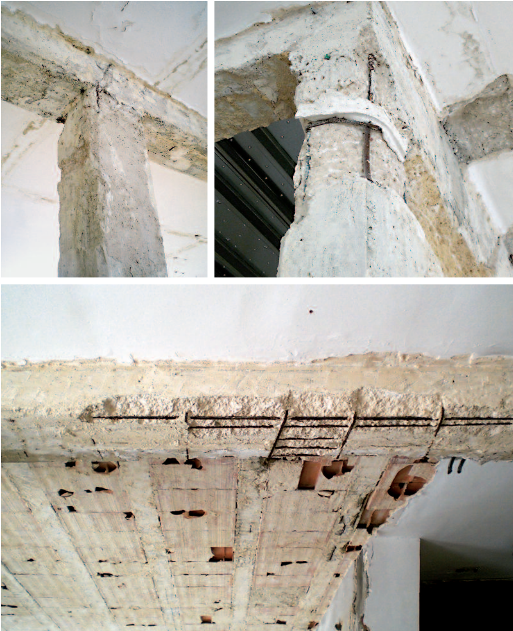
Figura 1 Valutazione dello stato di fatto, dettagli riguardanti la carbonatazione del calcestruzzo degli elementi strutturali, la perdita di copriferro e l'ossidazione dei ferri di armatura esposti.
