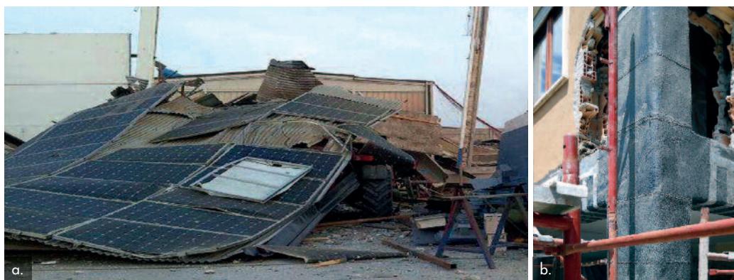
Figura 2 Rischi di un approccio alla riqualificazione che trascuri le carenze strutturali degli edifici: (a) Crollo di un capannone industriale con installati pannelli fotovoltaici a seguito del terremoto in Emilia-Romagna (2012); (b) Esempio di un intervento volto al solo rinforzo sismico mediante fasciatura dei nodi con fibre di carbonio e resina.
