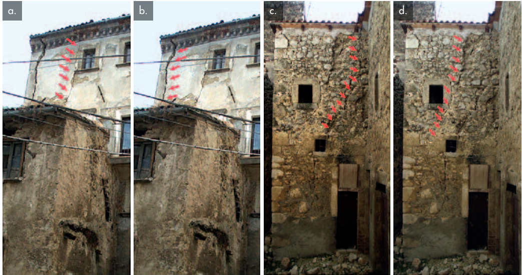
Figura 10 Formazione ed evoluzione di due meccanismi a cuneo singolo, Casentino, (AQ); (a, c) prima fase: fessurazione e distacco di un'ampia porzione di muratura con \beta > 30^\circ ; (b, d) Seconda fase: l'evoluzione del meccanismo procede con l'apertura di una seconda lesione, meno inclinata, che delimita una porzione più piccola di muratura.
