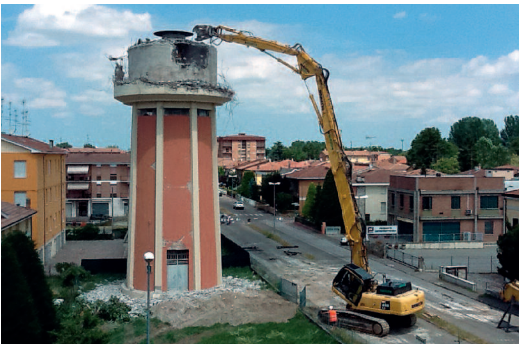
Figura 3 Demolizione di una delle torri piezometriche danneggiate dal terremoto che ha colpito l'Emilia Romagna (per gentile concessione Gesteco Spa, www.lucigroup.com ).
