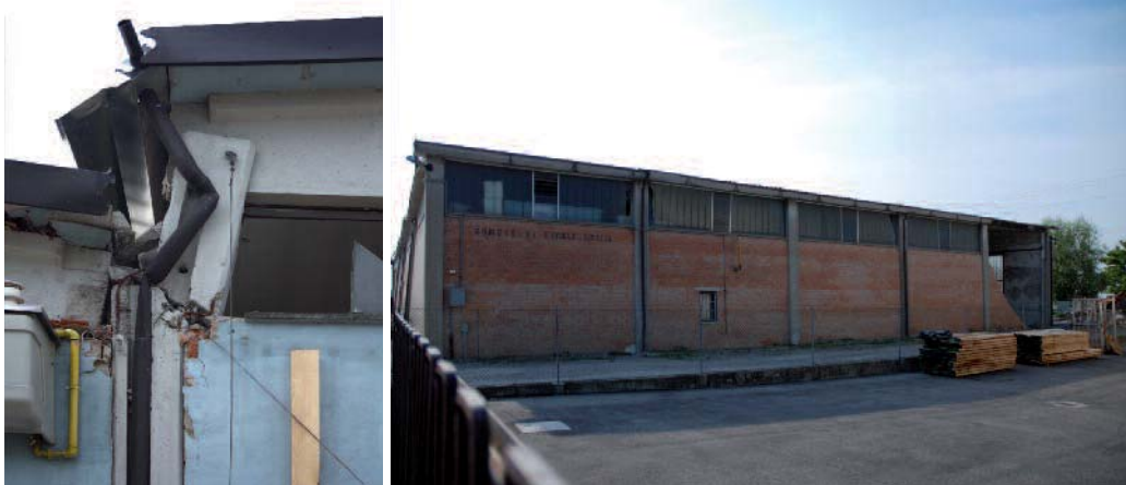
Figura 3 Danneggiamento della testata di un pilastro in corrispondenza della finestratura a nastro (a sinistra) e danneggiamento pannello in muratura (a destra) (terremoto Emilia 2012).
