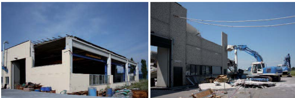
Figura 2 Perdita di appoggio dei pannelli. (terremoto Emilia 2012).
