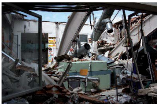
Figura 1: Crollo della copertura dovuto alla perdita di appoggio delle travi principali (terremoto Emilia 2012).
