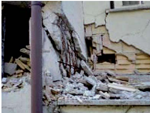
Figura 5 Rilievo di alcune lesioni esterne dell'edificio 2 (Figura 2): particolarmente concentrate nella zona del vano scala a piano terra.
