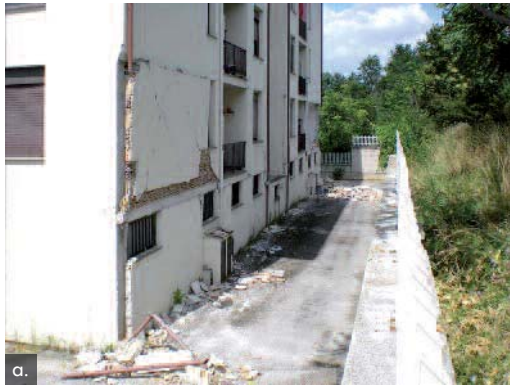
Figura 6 Rilievo di alcune lesioni esterne degli edifici 2 e 3 (Figura 2): a) e via Francia 28 b) del lato nord ovest.
