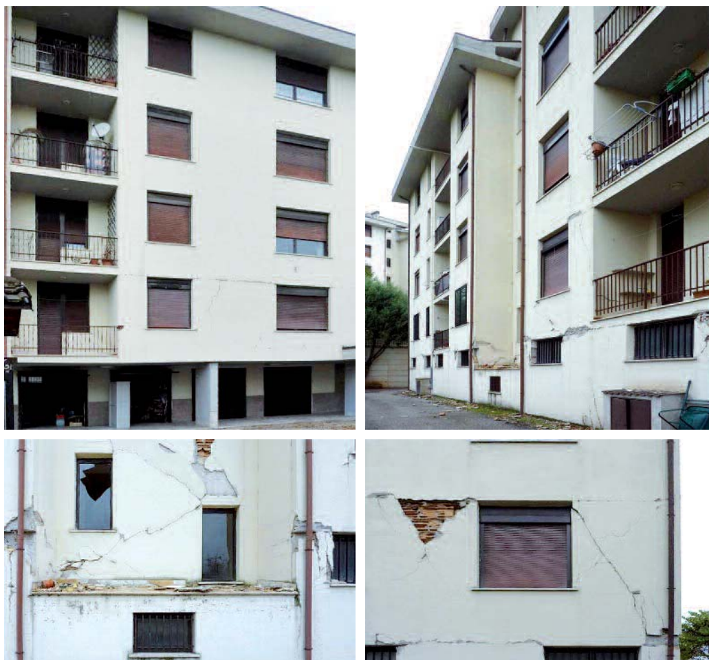
Figura 8 Rilevato di alcune lesioni esterne dell'edificio 1 (Figura 2): danno rilevato meno esteso e di grado inferiore rispetto agli edifici 2 e 3.
