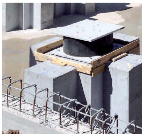
Figura 21 Casseratura in testa ai pilastri e getto di completamento al di sotto della base degli isolatori.
