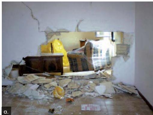
Figura 7 Rilievo di alcune lesioni degli edifici 2 e 3 (Figura 2): danneggiamento dei tamponamenti interni a) ed esterni b).
