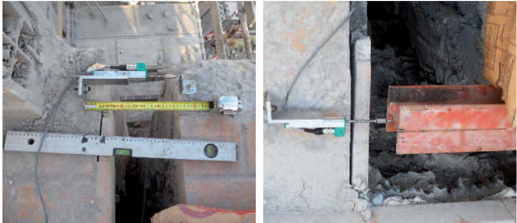
Figura 14 Posizionamento dei traduttori a livello di solaio per la misura degli spostamenti fuori piano.
