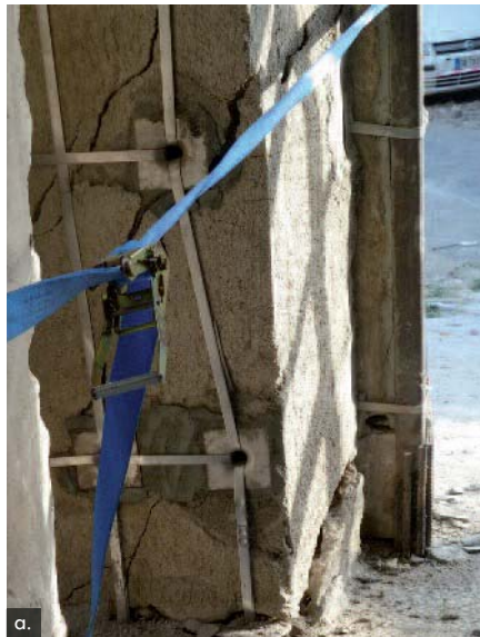
Figura 32 Prova su arco rinforzato danneggiato: rotazione del pedritto di destra a) nel piano; b) fuori piano (a destra).
