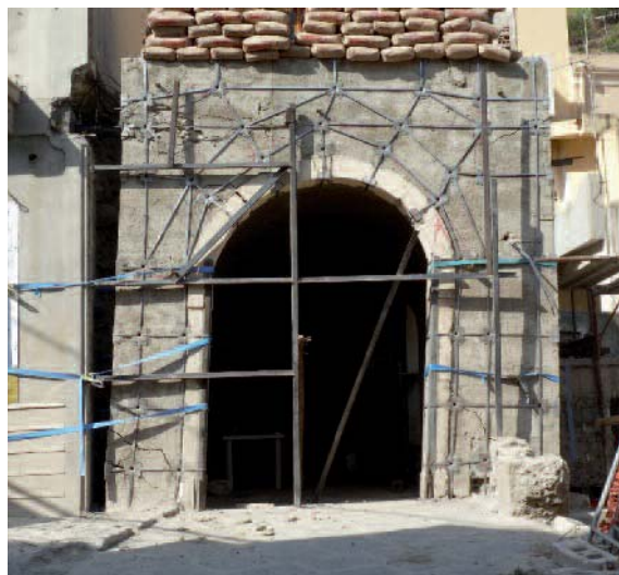
Figura 28 Prova su arco rinforzato danneggiato: danneggiamento durante l'ultimo ciclo di carico.
