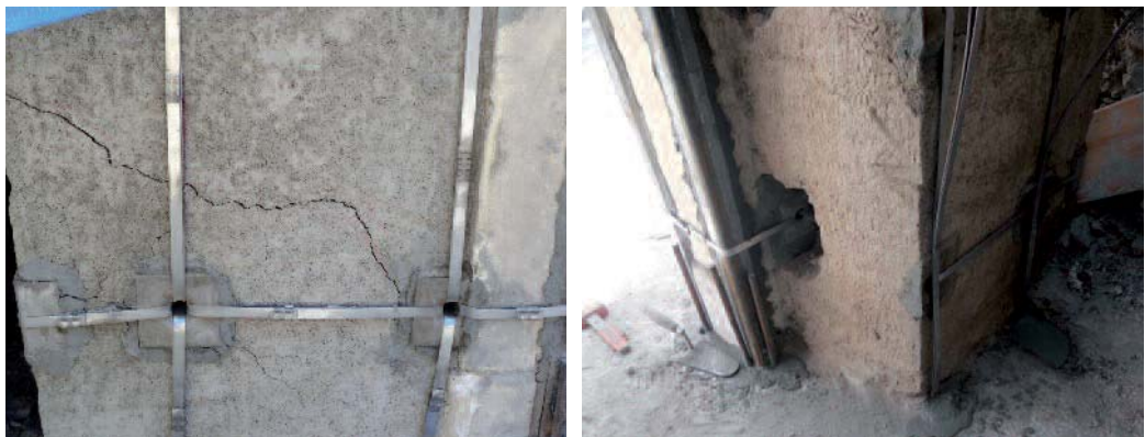
Figura 24 Prova su arco rinforzato: lesione n. 2, piedritto di sinistra.
