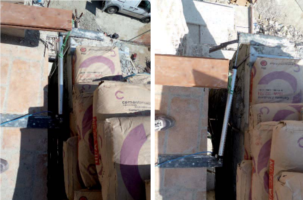
Figura 33 Trasduttore di spostamento in testa al pannello, pre e durante le prove. Oltre a rilevare uno spostamento nel piano dell'arco, si evidenzia un notevole fuori piombo.
