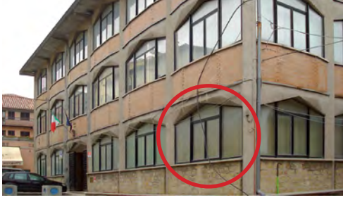
Figura 9 Vista anteriore del corpo A con evidenziata la geometria di travi e pilastri.
