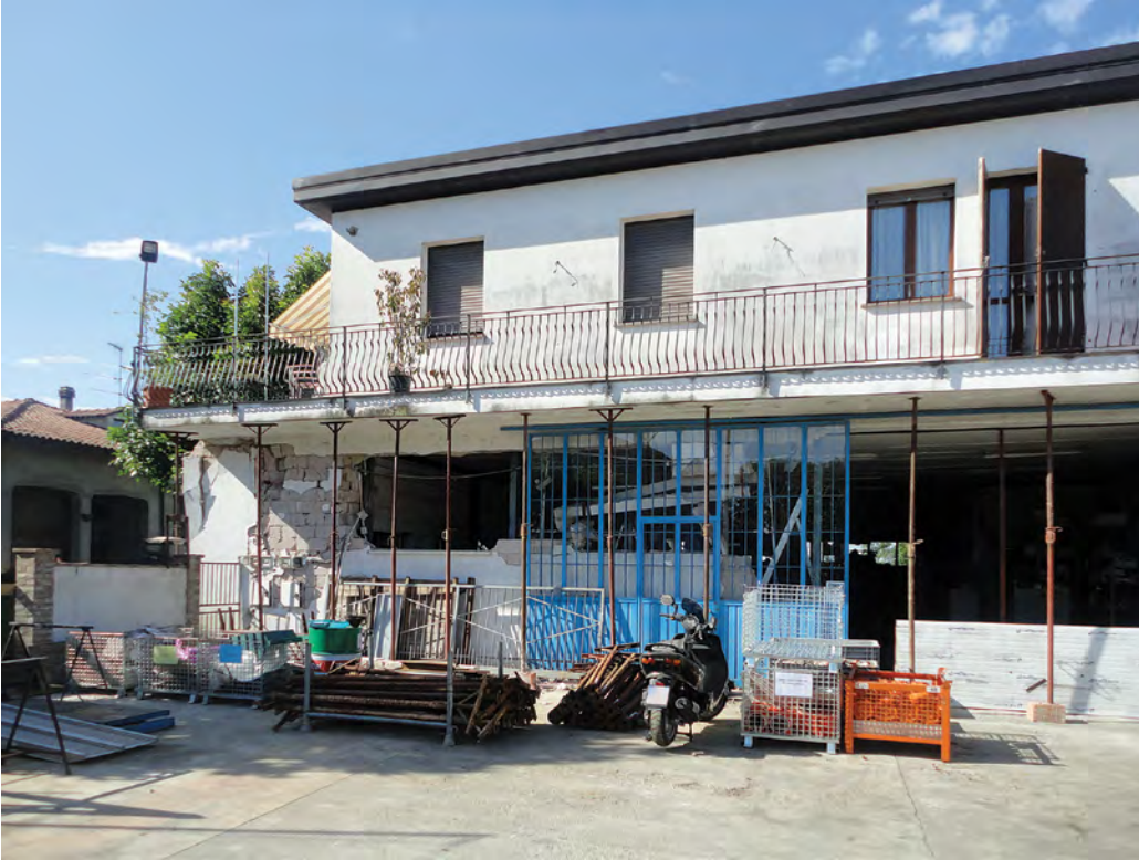
Figura 2 Facciata principale (nord) del fabbricato, con danni e crolli parziali in seguito alle azioni sismiche.
