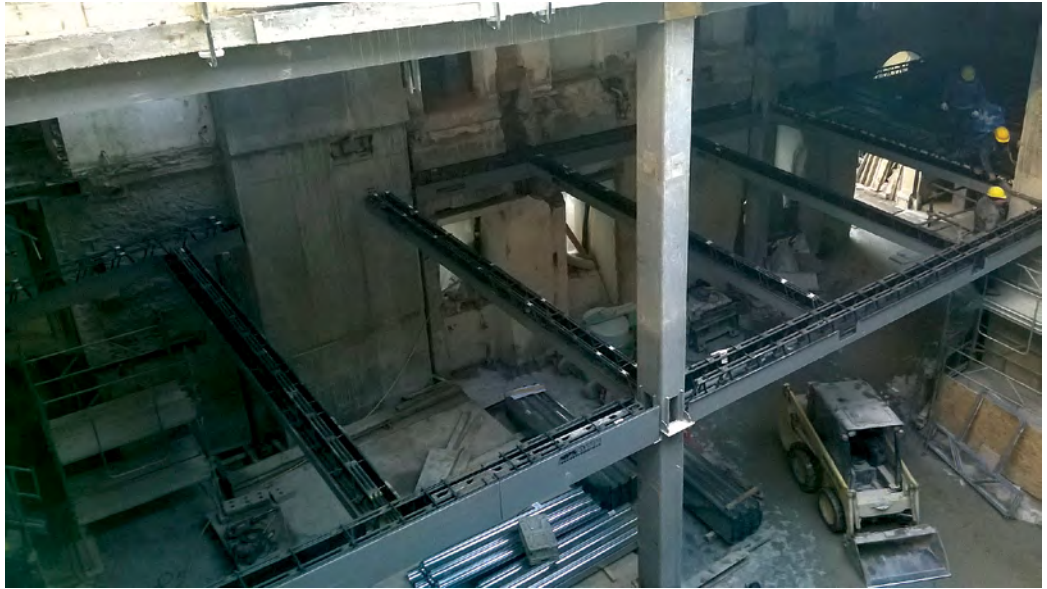
Figura 21 Nell'ambito della soluzione adottata, le travi sono autoportanti in fase di montaggio e getto dei solai. Questo ha comportato una notevole riduzione dei tempi di esecuzione, permettendo, una volta terminato il montaggio di una porzione di solaio, di demolizione la porzione sottostante in totale sicurezza.
