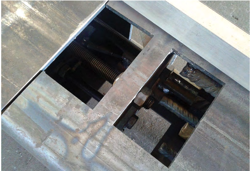
Figura 18 Le giunzioni dei pilastri sono realizzate in corrispondenza della mezziera di ogni interpiano, dove risultano minime le sollecitazioni flettenti, attraverso barre filettate, dadi, flange e fazzoletti di irrigidimento. Le flange di giunzione sono posizionate in modo da prevedere la possibilità di regolare in altezza e garantire la verticalità di ogni elemento, agendo sui bulloni di giunzione.
