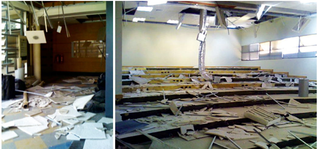
Figura 14 Danni a controsoffitti e impianti illuminanti presso la Universidad de Chile. ( http://romano.in/tag/beauchef/page/4/ ).
