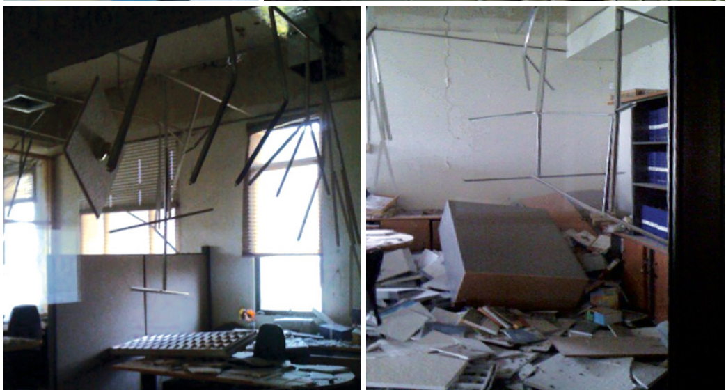
Figura 15 Danni a controsoffitti e contenuti alla Universidad de Chile. ( http://romano.in/tag/beauchef/page/4/ ).
