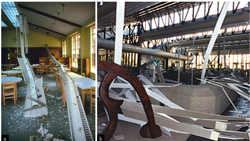
Figura 5 a) Collasso di impianti di illuminazione alla Northridge Junior High School. (FEMA-E74); b) Danni ai controsoffitti e ad una scultura in legno presso la Thousand Oaks Library. ( http://content.cdlib.org/ark:/13030/c8fn146t/?layout=metadata ).
