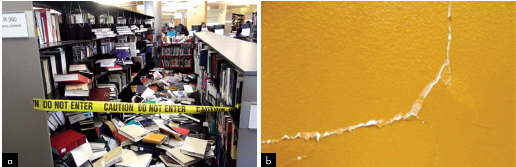
Figura 20 a) Libri caduti dalle rispettive scaffalature all'interno della McCarthy Library (Napa Valley College); b) Fessurazione di partizioni in cartongesso (Liceo nel centro di Napa). (Kang and Mahin 2014).
