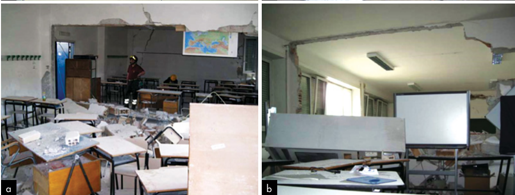
Figura 13 a) Collasso di un muro di partizione presso l'Istituto Tecnico per le Attività Sociali E. di Savoia; b) Collasso di un muro di partizione e di una serie di armadi presso l'Istituto Tecnico per le Attività Sociali E. di Savoia. (Salvatore et al. 2010).
