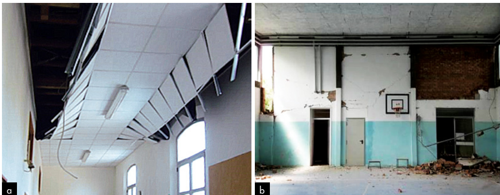
Figura 19 a) Controsoffitti danneggiati in un edificio scolastico. (D'Ainello et al. 2012); b) Vista della palestra nella scuola elementare "Anna Frank". (Occhiuzzi et al. 2012).
