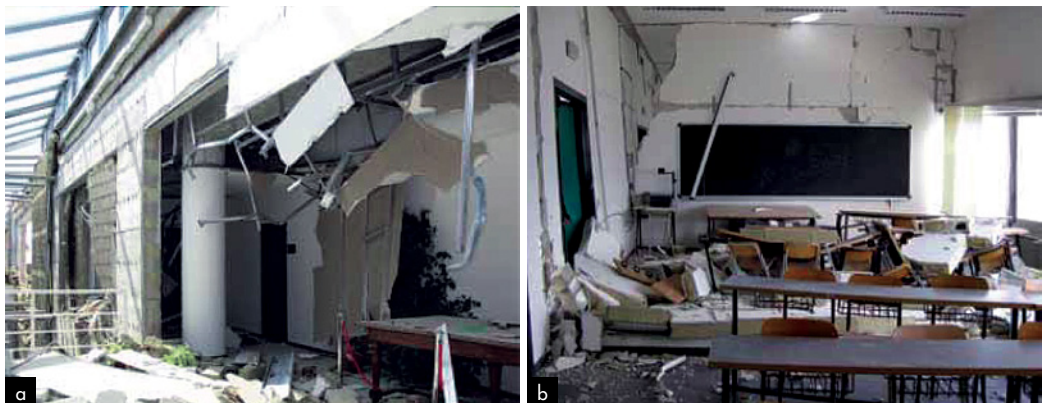
Figura 10 a) Collasso di controsoffitti all'Università di L'Aquila; b) Collasso di muri di partizione in un'aula presso l'Università di L'Aquila. (Global Risk Miyamoto, 2009).
